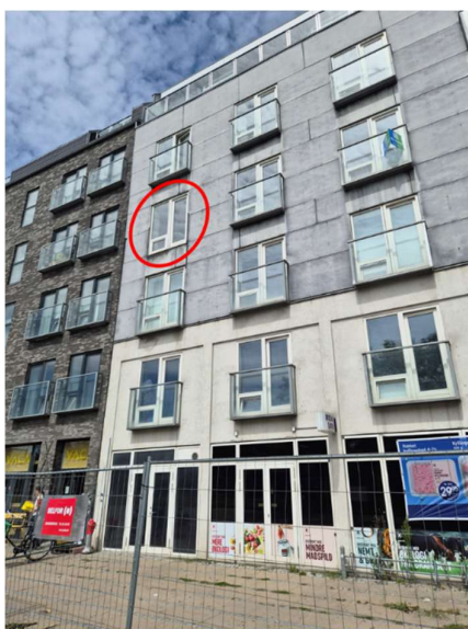
Figur 3.1 Fotografi af bygningen efter at altanen er faldet ned
