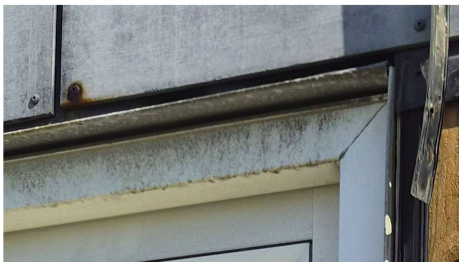
Figur 3.7 Fugtphobning over vinduesramme ledes ikke væk og trænger ned i facadekonstruktionen, herunder langs afstandslisten,
