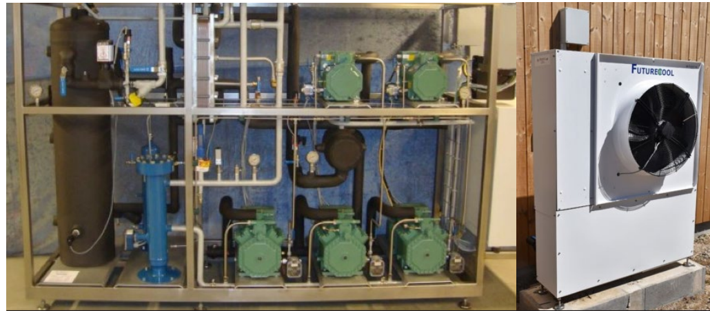
Figur 49 - Eksempel af et CO 2 køleanlæg. Indendørs (til venstre) og udeenhed (luftkølet kondensator) (til højre) Kilde: JF køleteknik A/S
