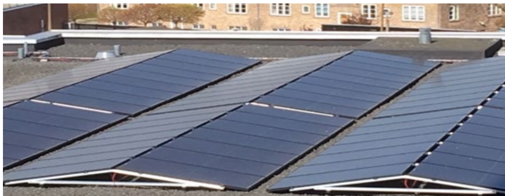
Figur 5 - Eksempel af solcelleanlæg på fladtage (orientering mod øst/vest)
