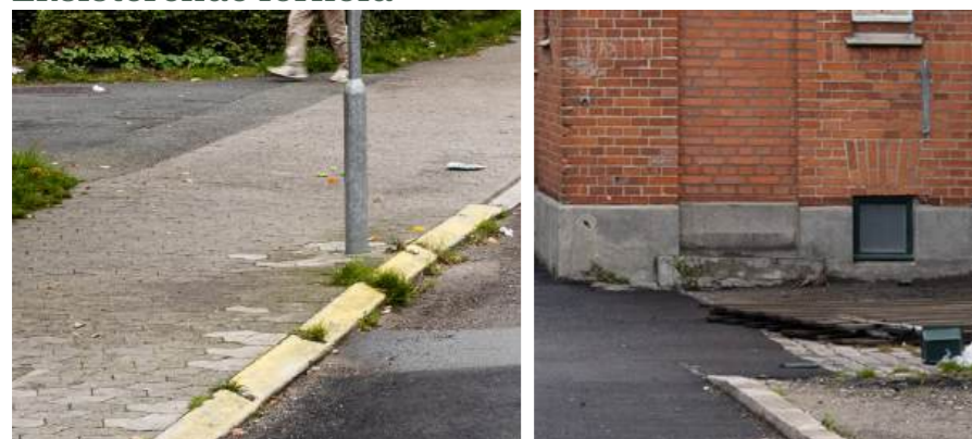
01-2 Slidte betonfliser, SF sten og asfalt belægninger.
