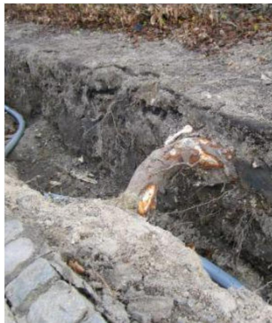
Billede 1: Eksempel på gravning, hvor der er håndgravet. Dog er der inden håndgravning gravet maskinelt og rod er blevet skadet overfladisk.
