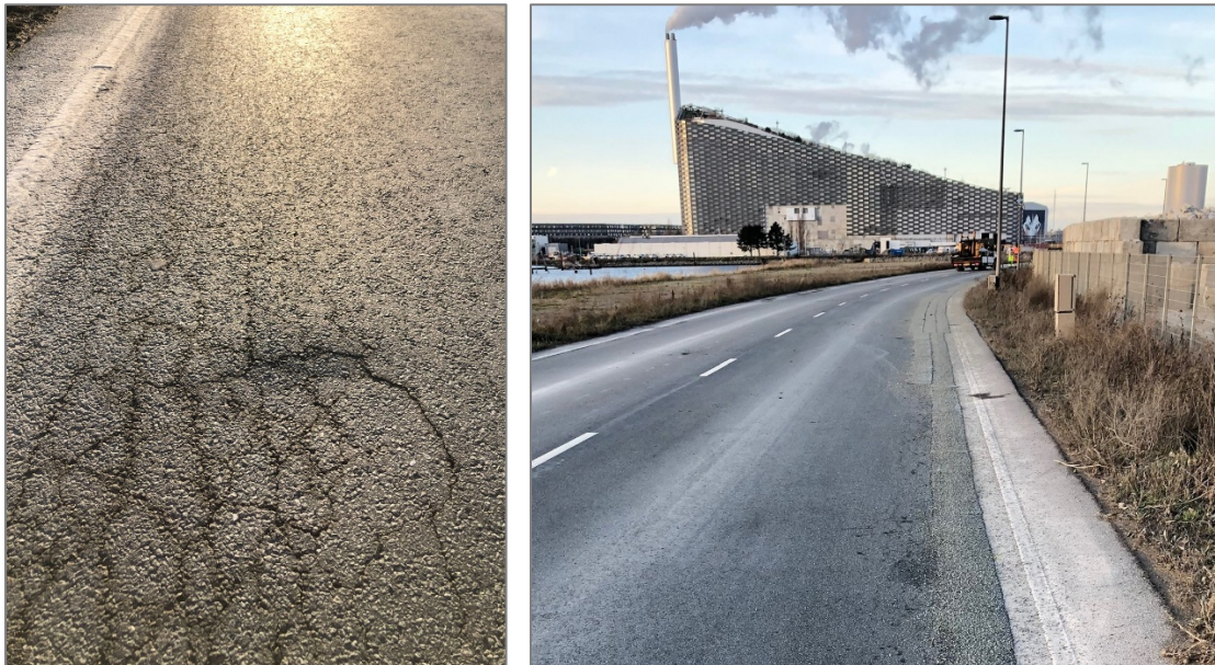
Figur 10. Revnedannelse samt reparationsarbejder på Jordtransportvej.
