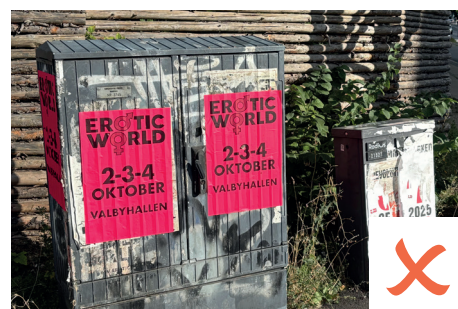
Det er ikke tilladt at hænge plakater på teknikskabe (foto Københavns Kommune)
