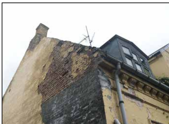
Husmur i dårlig stand.
