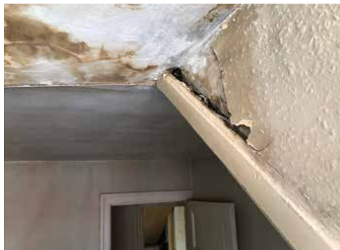
Loft med fugtskader og skimmelsvamp.
