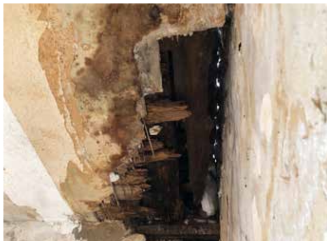
Taglejlighed med hul i væg/loft.
