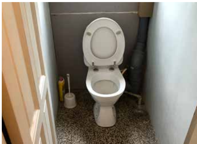
Toilet på bagtrappen er uden håndvask og varme.
