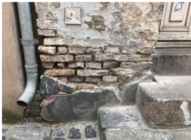
Udvendig vandskade på sokkel.
