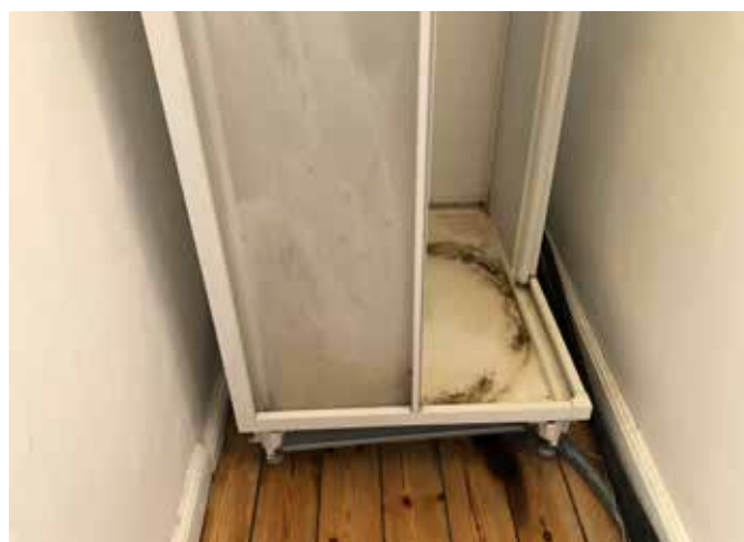
Brusekabine uden fugtsikring.
