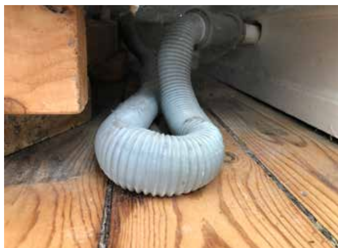
Afløb uden vandlås.
