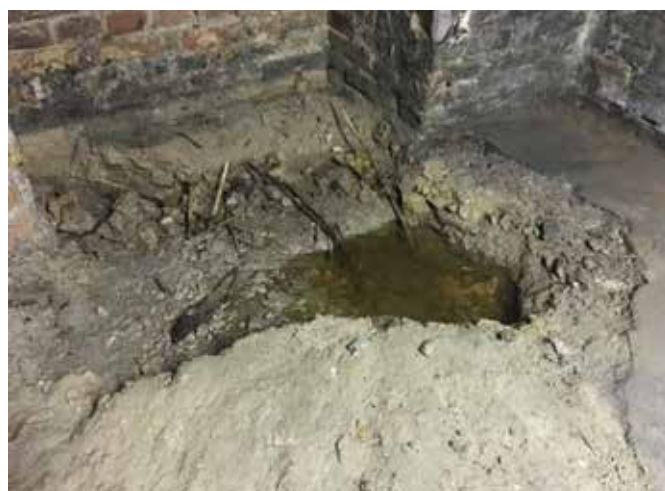
Hul i kældergulv fyldt med vand.
