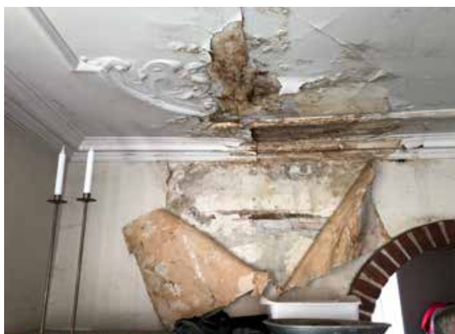
Vandskade på grund af utæt tag.
