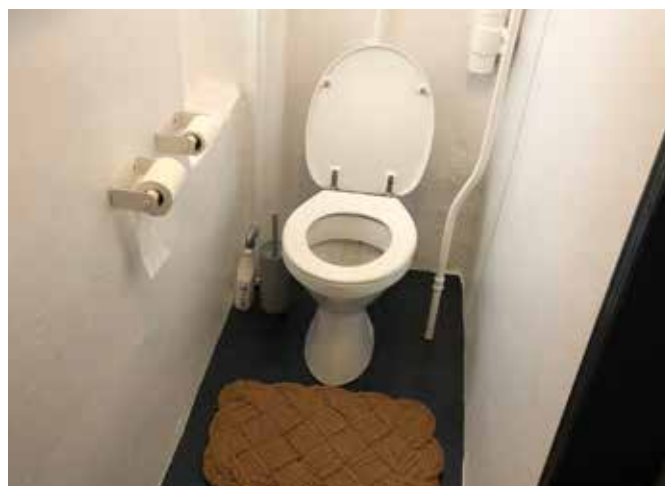
Toilet uden håndvask eller opvarming.
