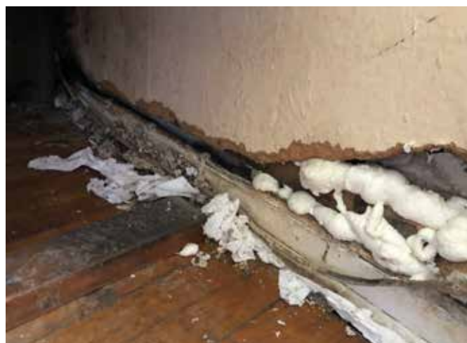
Rotter har gnavet i væg, isolering og ledninger.
