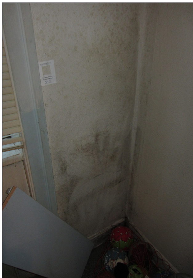
Flere af væggene er alvorligt ramt af skimmelsvamp.
