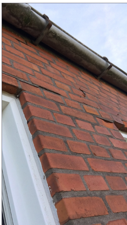
Beskadigede fuger og teglsten ved tagfod.
