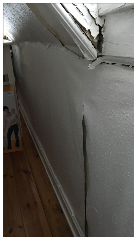
Nedbrudt væg mod skunk i soveværelse.
