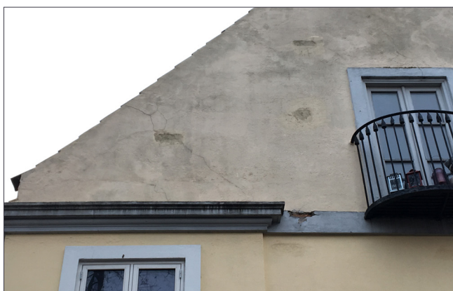
Sætningsskader i gavl mod Vibekevej.
