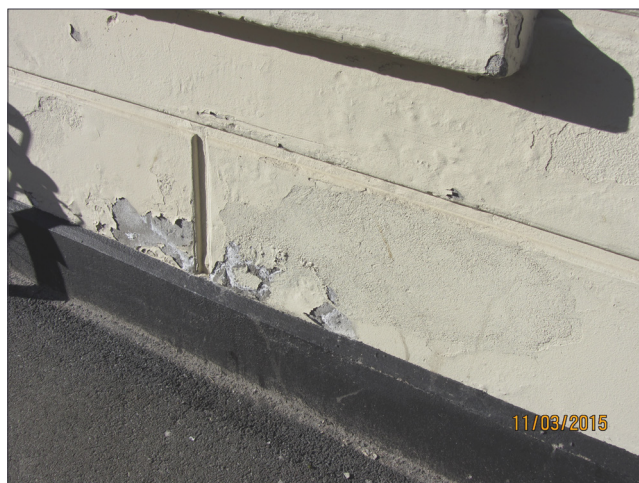
Opfugtet og afskallet gadefacade
