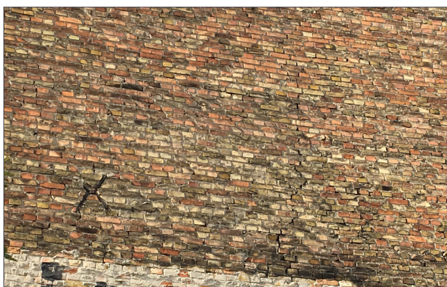
Sætningsrevne i gavl.
