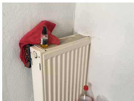
Radiator opdelt af skillevæg mellem boliger.
