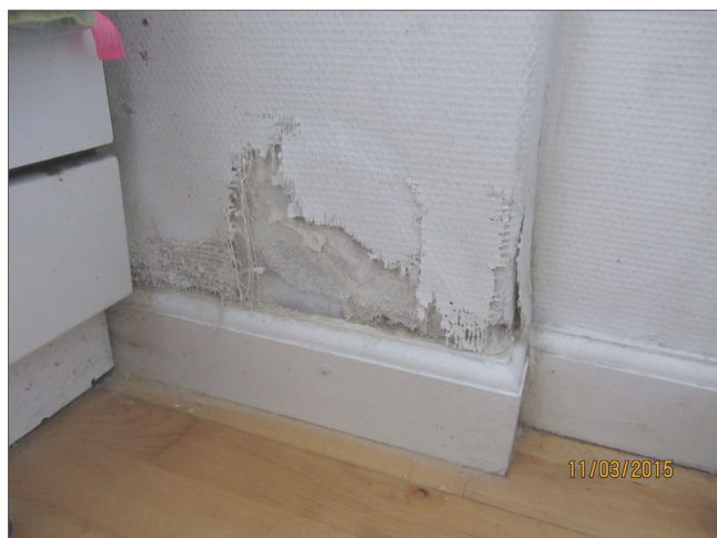
Grundfugt i ydervæg, nr. 16 st.
