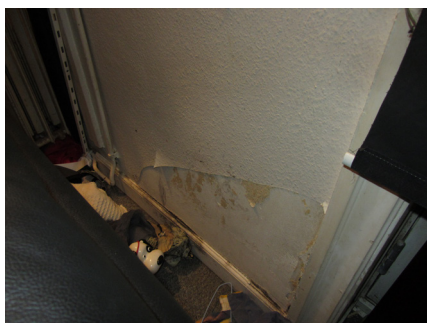
Den manglende udluftning har ført til løst tapet.
