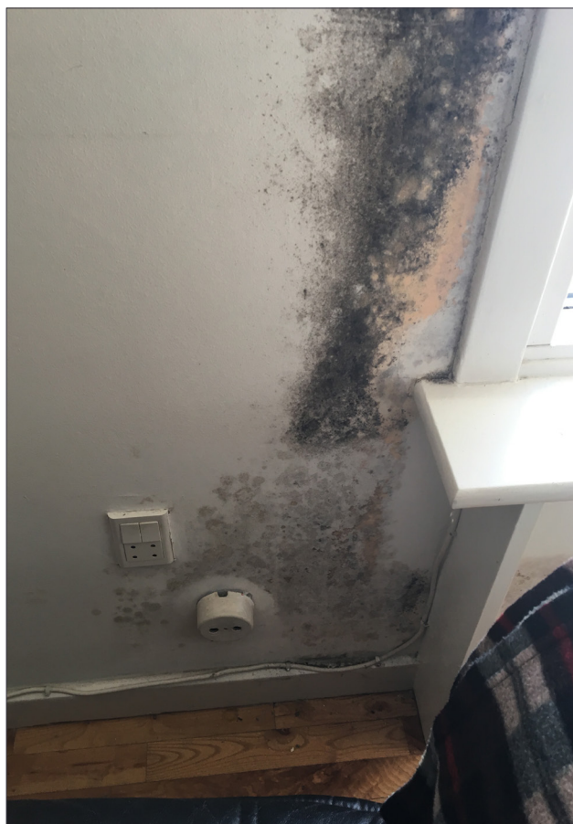
Skimmelsvamp ved vindue i stuen.
