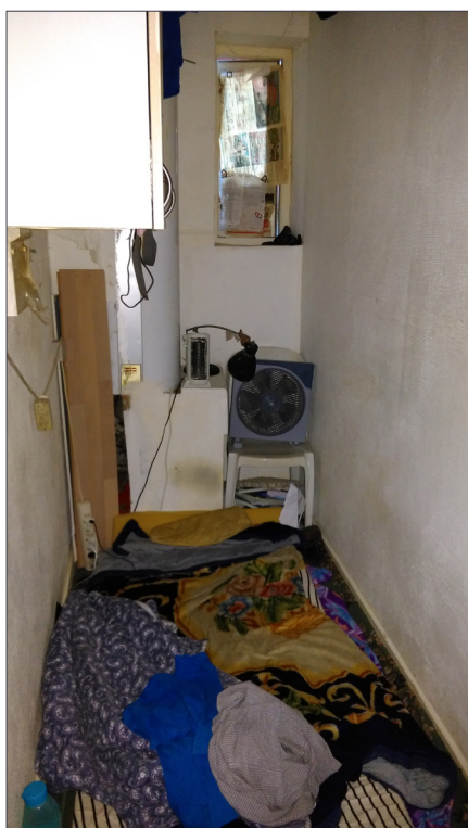
Kælderbolig med utilstrækkelige flugtveje.
