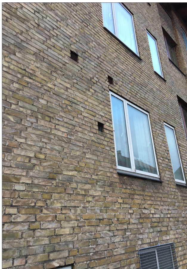
Friskluftventiler i gadefacaden.
