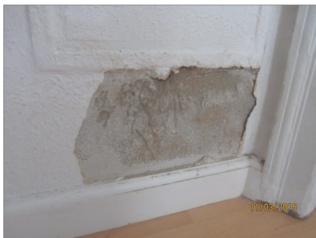
Fugt i væg mod gennemgang, nr. 18, st. th.
