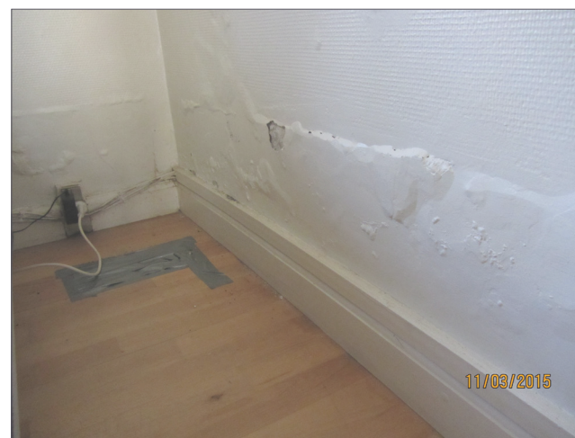
Fugt i gavlvæg, nr. 16 st.
