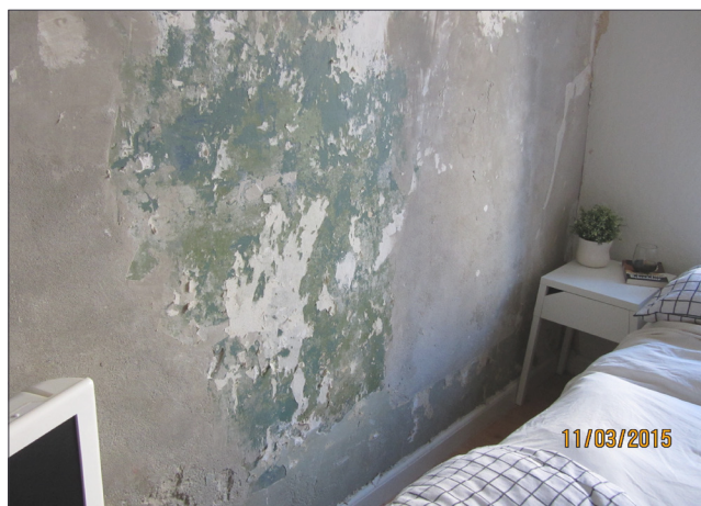
Fugt i væg mod køkken, nr. 18 st. th.
