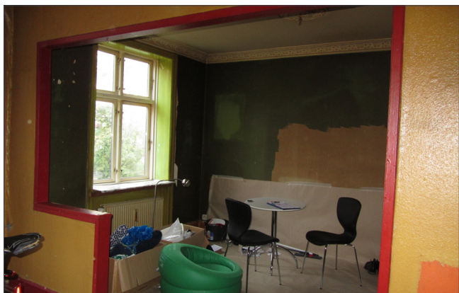
Opholdsrum i nedslidt lejlighed, Mimersgade 52, 2. th.
