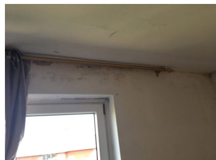
Skimmelsvamp ved vindue i stuen.
