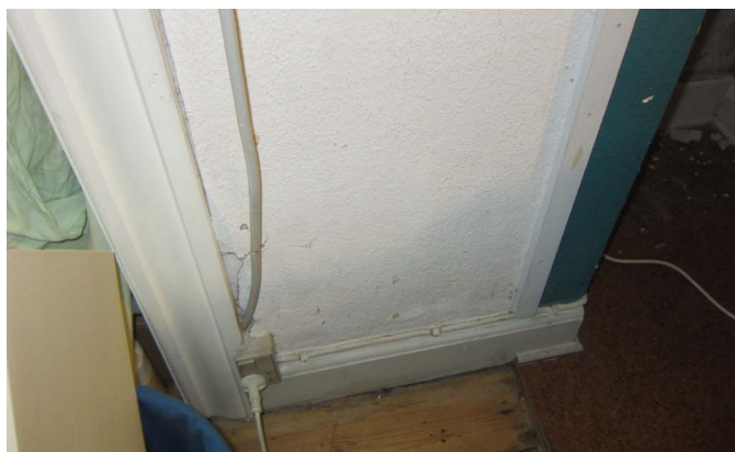
Fugt og skimmel i væg
