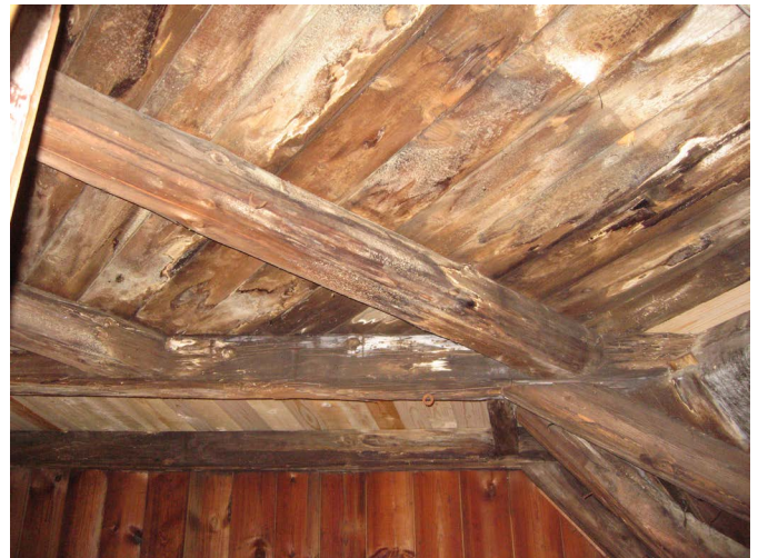
Fugt/råd i tagkonstruktion, sidefløjen tv.
