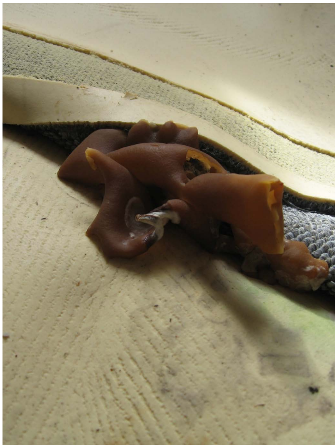
Sundevedsgade 5-7, bægersvamp på gulvet i tagetagen
