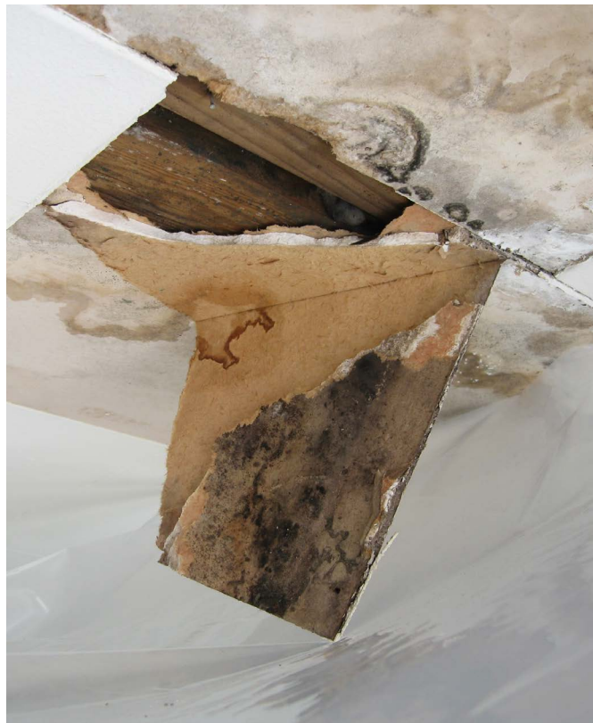
Fugt og skimmel i loft i tagetagen
