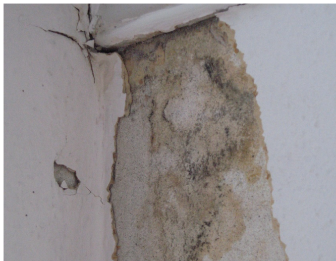
Skimmel på væg i opholdsrum
