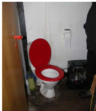
WC ført til sivebrønd
