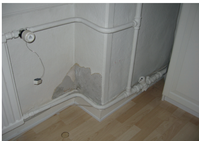
Grundfugt i ydervæg
