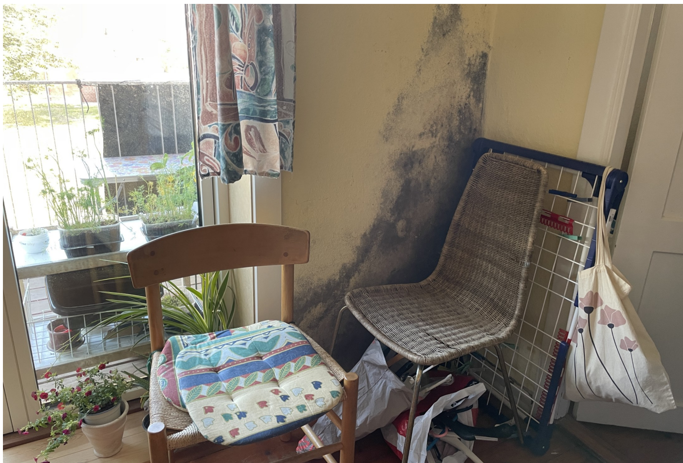
Bolig med skimmelsvamp i sundhedsskadeligt omfang.
