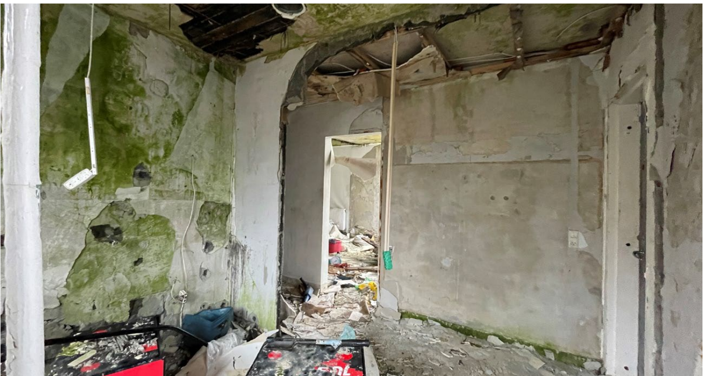
Ejendom hvor afspærring og nedrivning blev påbudt.
