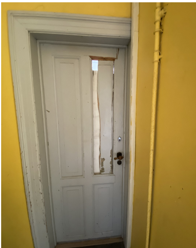
Beskadiget dør til bolig.
