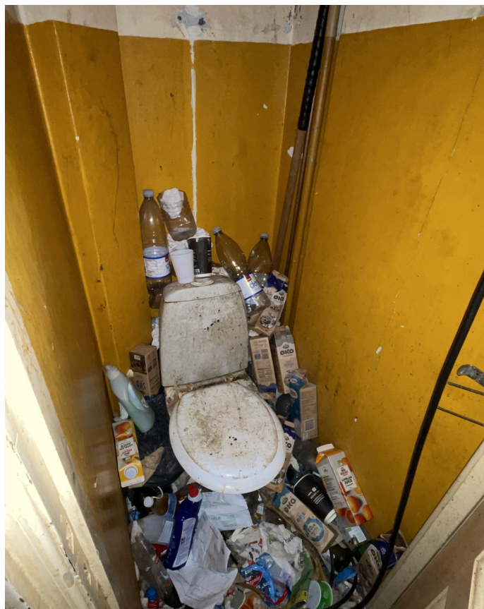
Defekt wc i bolig, som ikke var tilsluttet vand.
