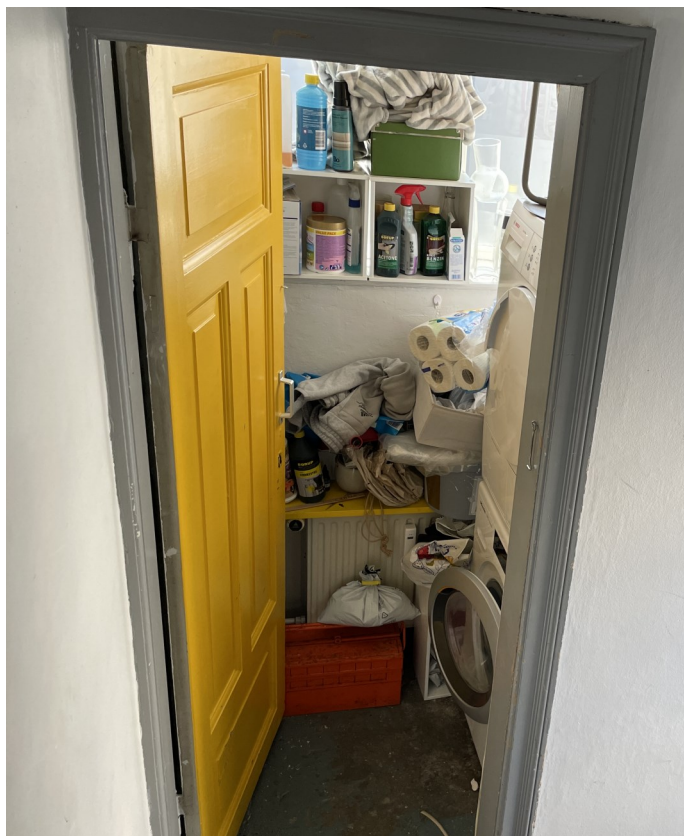
Nedlagt wc-rum uden branddør, der benyttes som depot.
