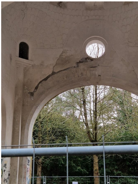
Revner i selve murværket samt skader på puds
