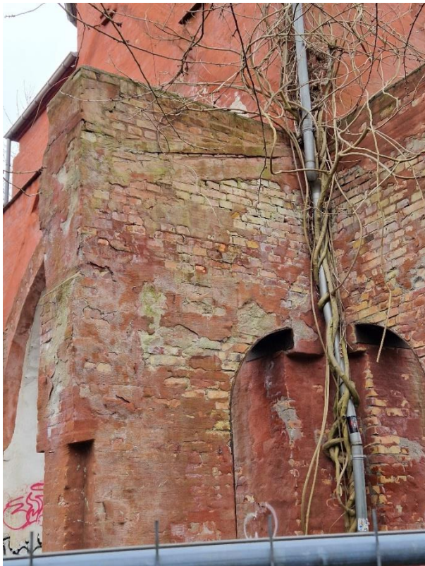
Afskalninger på mursten på ydersiden.
