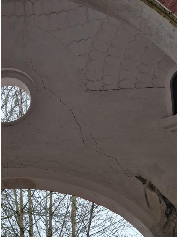
Gennemgående revner samt afskallet puds
