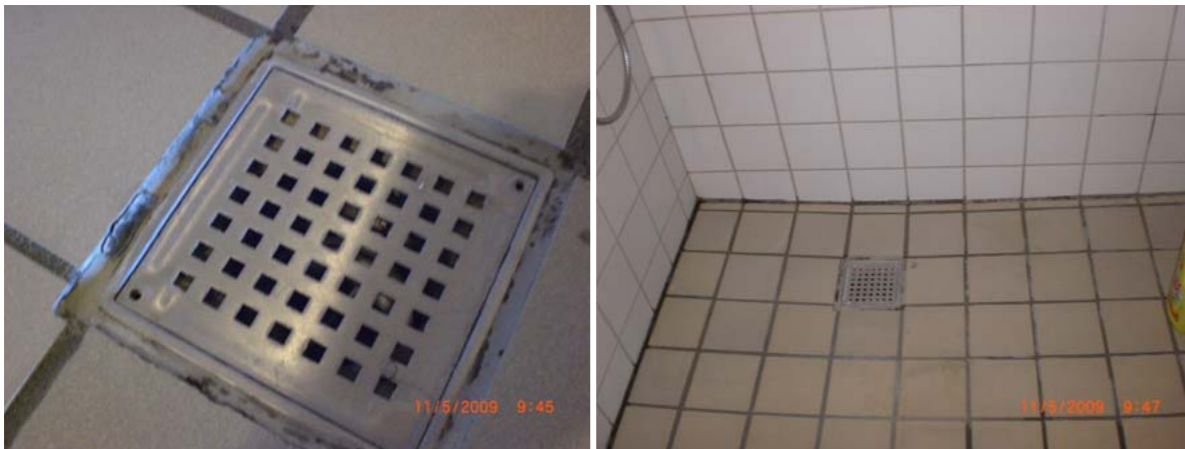
Fotoregistrering fra "Rapport vedrørende visuel gennemgang af badeværelser", FHA Consulting, 2009. Frankrigsgade 6. 1. th.
