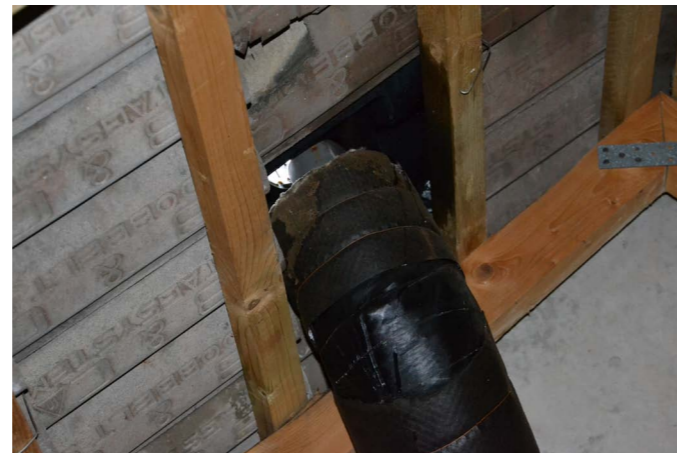
Utætheder ved taggennemføring.
