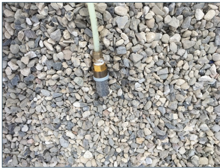
Figur 13 Målepunkt – Eksempel på metalfilter monteret på PEX-rør.
