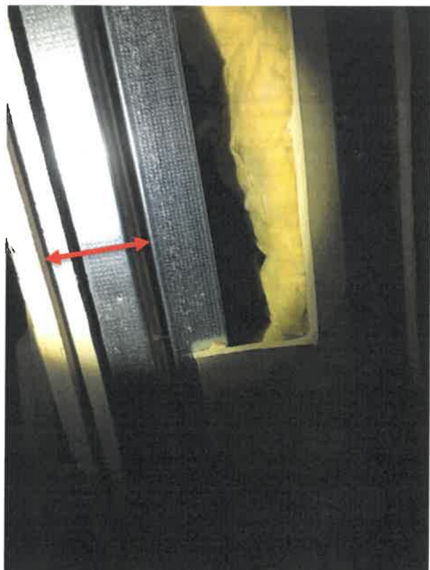
Foto 1.3 – 2.5. Åbning ved dør. Hulrum ved lysningspanel er ikke isoleret.
