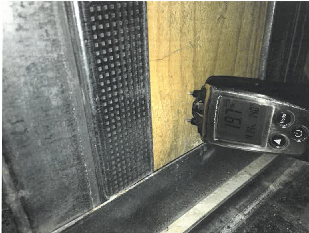
Foto 1.3 – 2.3. Åbning U01. Fugtmåling i krydsfiner mod udsparring for tagnedløb.
