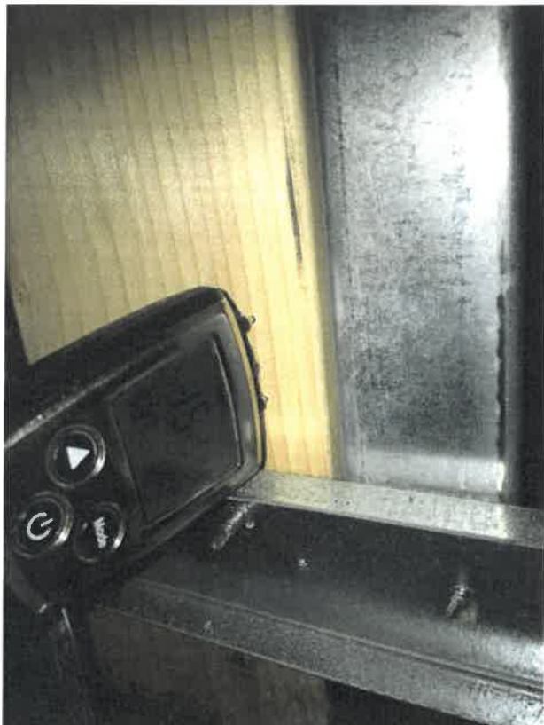
Foto 1.3 – 2.11. Åbning U02. Fugtmåling i trædetalje mod tagnedløb.
