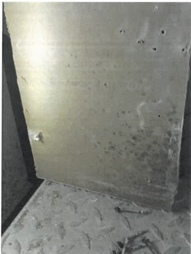
Foto 1.3 – 2.7. Åbning ved dør. Bagside af forreste gipskarton mod trapperum.
