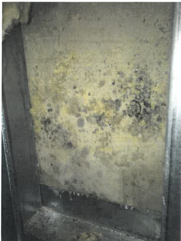
Foto 1.3 – 2.1. Åbning U01. Bagside af vindspærreplade.
