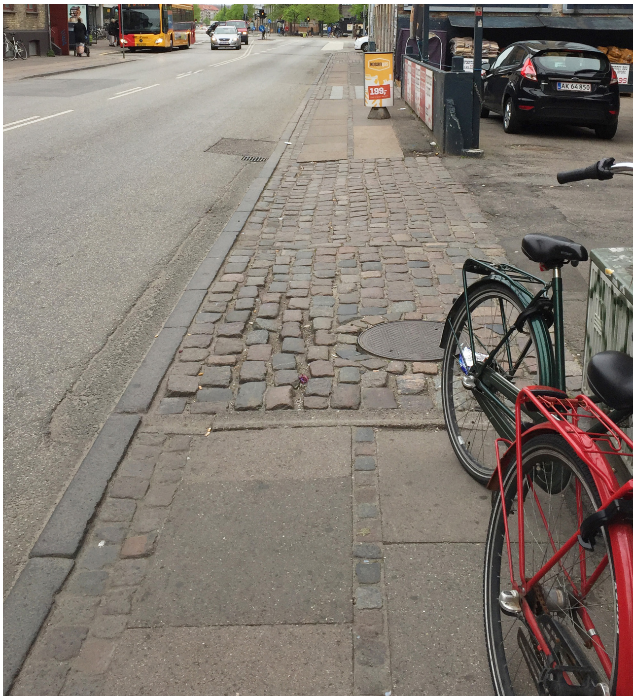
Foto af ujævn belægning på Fuglekvartersruten.
