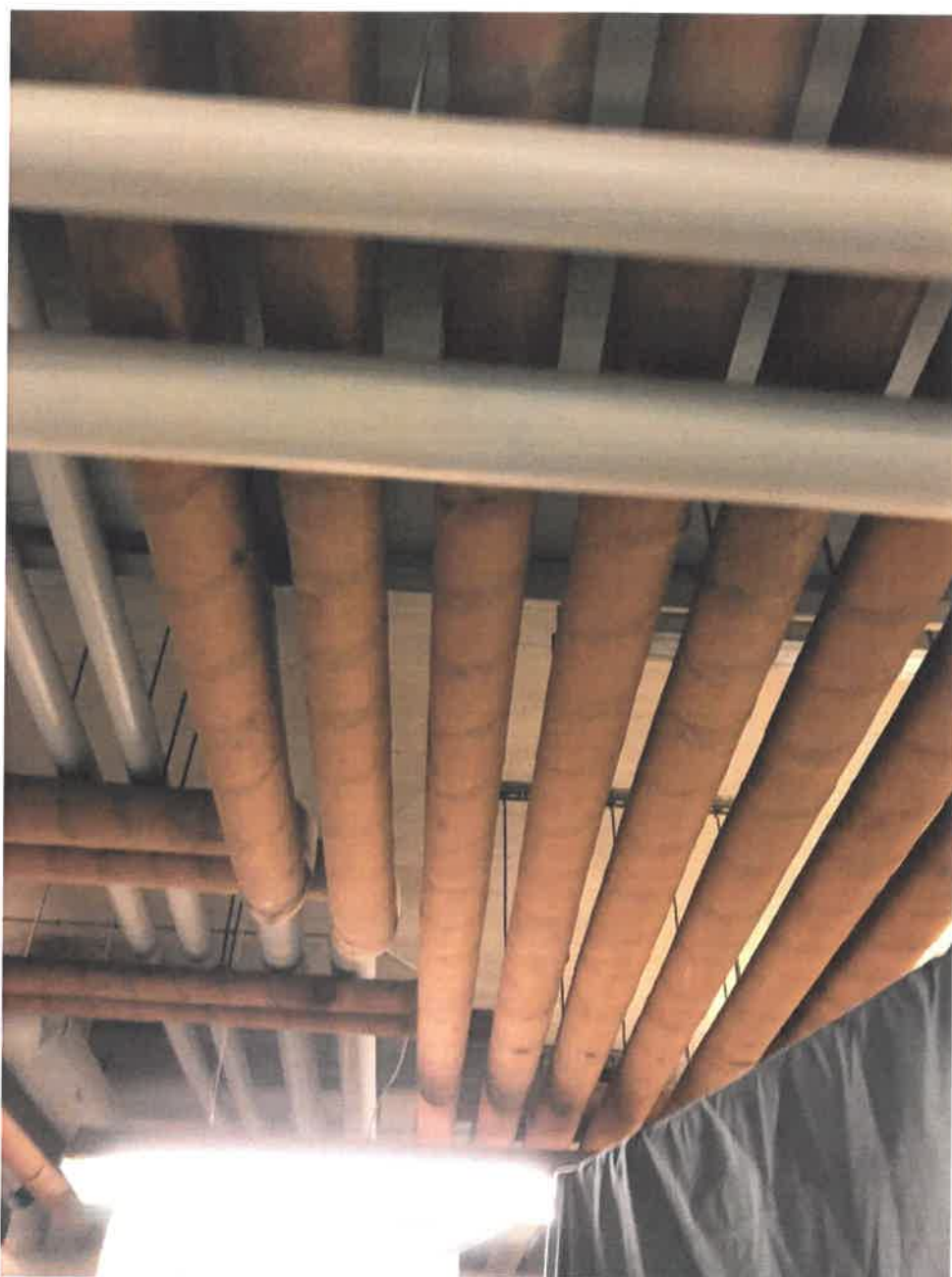
Fyr-/teknikrum med isolerede rør.
