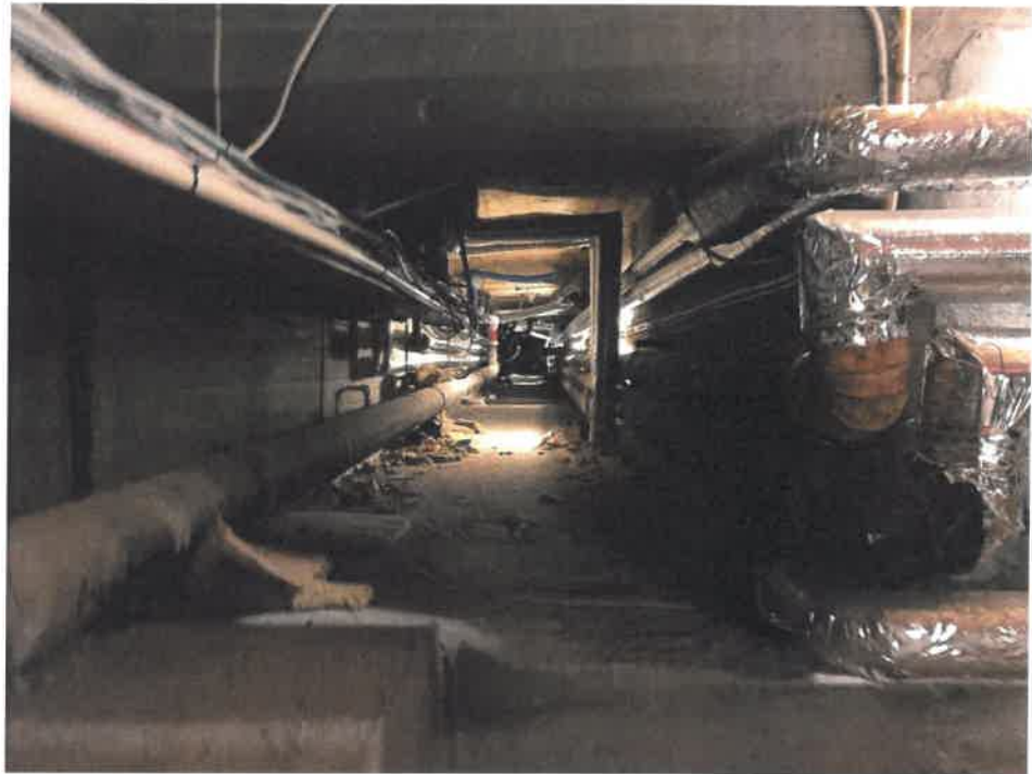
Ingeniørgang med isolerede rør.
