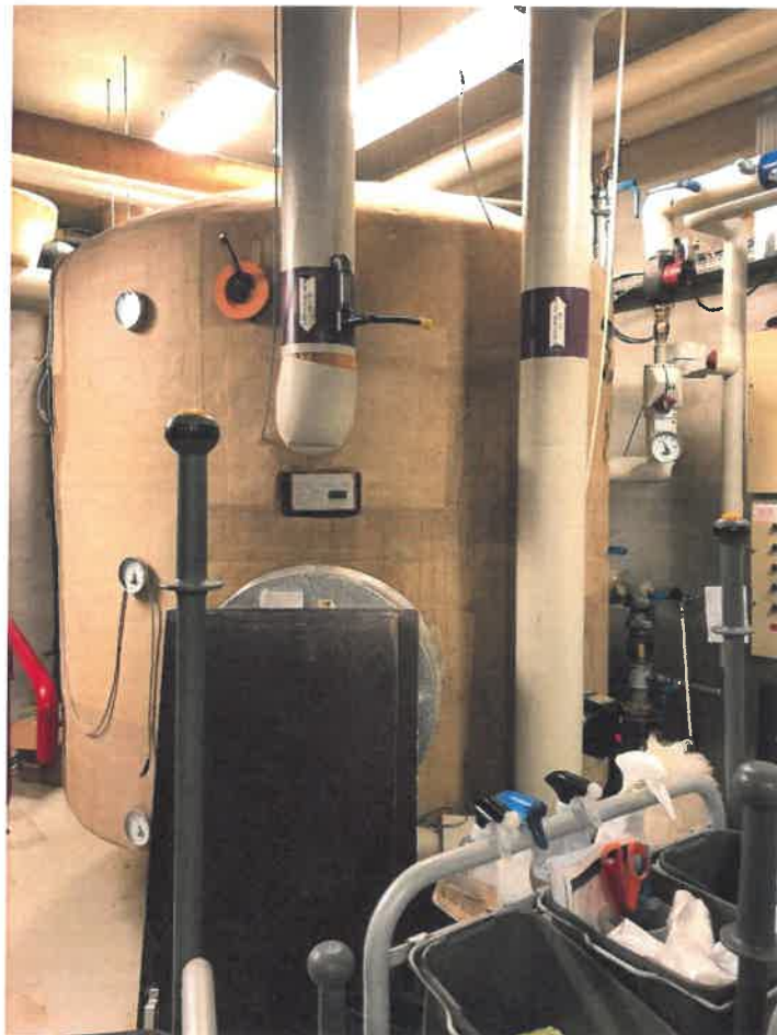
Fyr-/teknikrum med bemalet betongulv, ubehandlede betonvægge og isoleret kedel.
