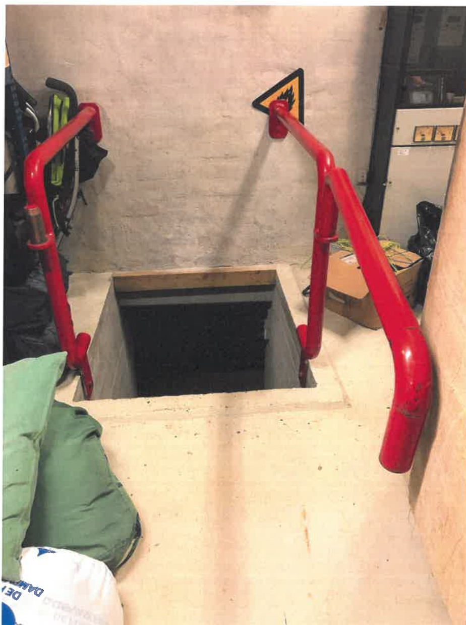
Fyr-/teknikrum med bemalet betongulv og nedgang til krybekælder.
