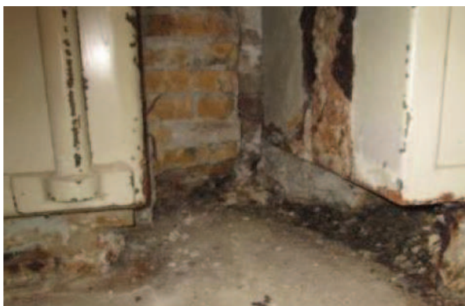
Fugtskade i kælder
