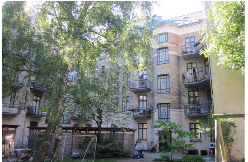
Efter udbedring af fundament erstattes den hårde belægning med permeabel belægning, der forsinket vandet på matriklen.
