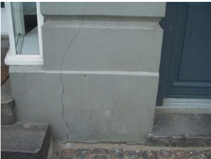
Sætningsrevne i gadefacade
