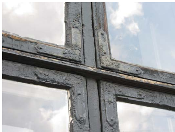
Udtjent vindue mod gaden
