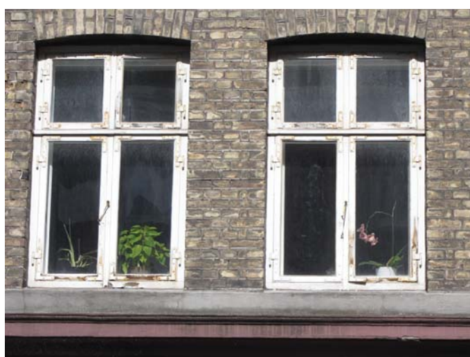
Vinduer mod Prinsessegade med behov for renovering
