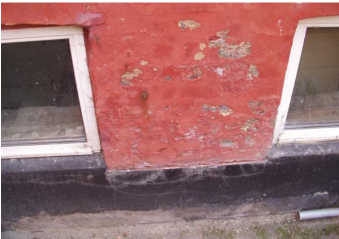
Fugtskadet underfacade mod gården
