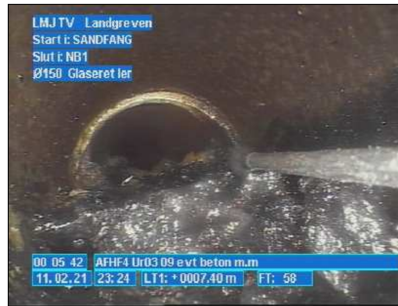
FOTO 058 00:05:41 7.4 m AFHF 4 evt beton m.m
