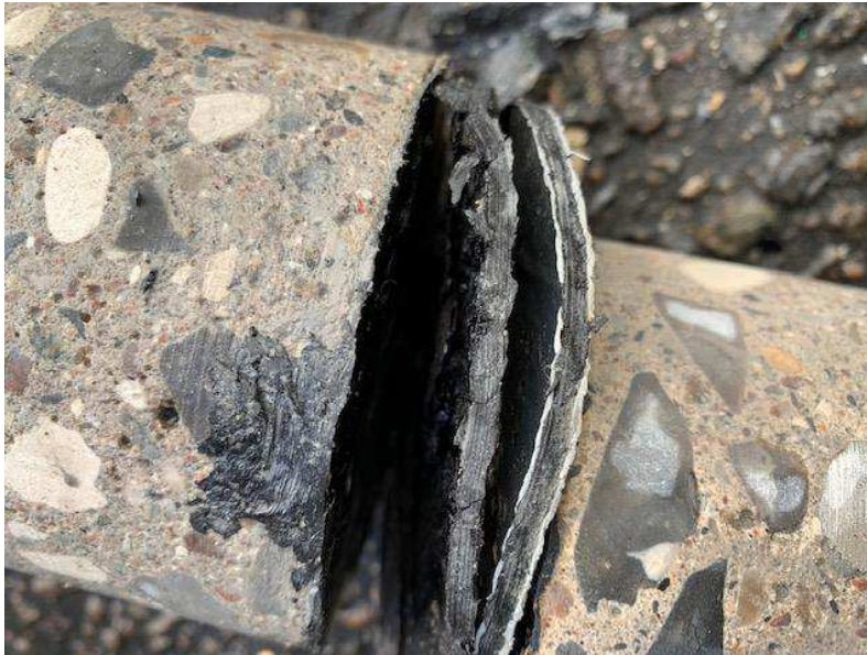
foto 1, Foto af snit i membran ved P1, membranen er udført af tjærepap.
