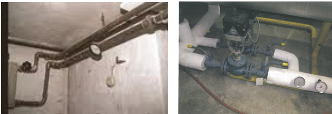
Motorventiler, afspærringsventiler og vandrør er uisolerede og giver uforholdsmæssigt stort varmetab
