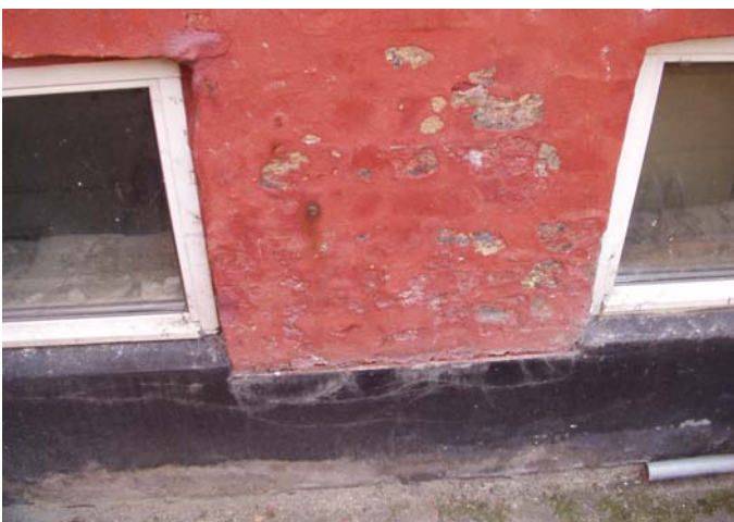
Fugtskadet underfacade mod gården
