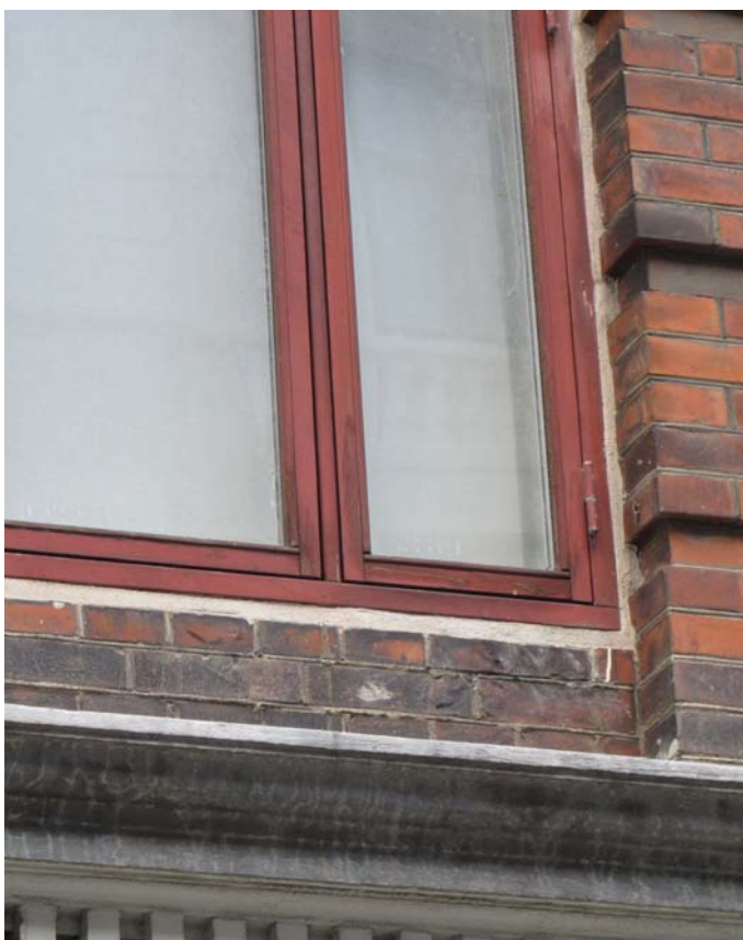
Ældre udtjent termovindue
