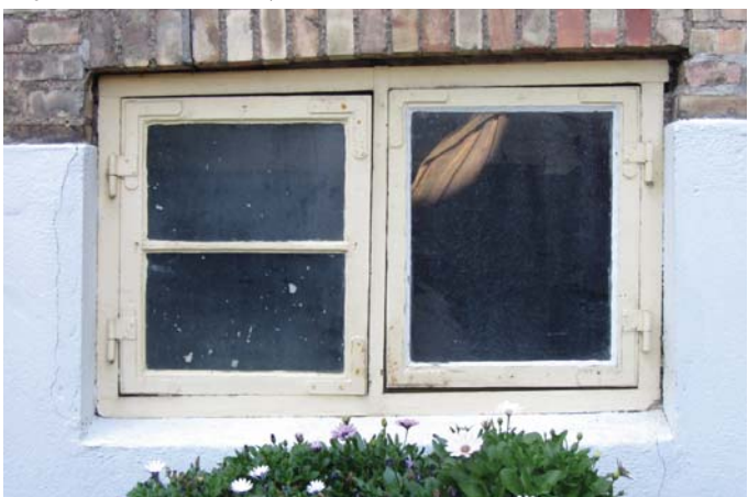
Deformt kældervindue Højenhald 14
