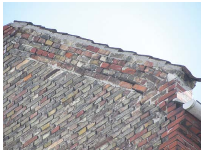
Nedbrudt bramdkam på baghusets vestgavl
