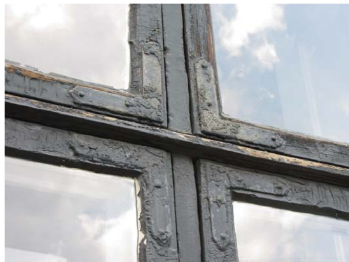
Udtjent vindue mod gaden
