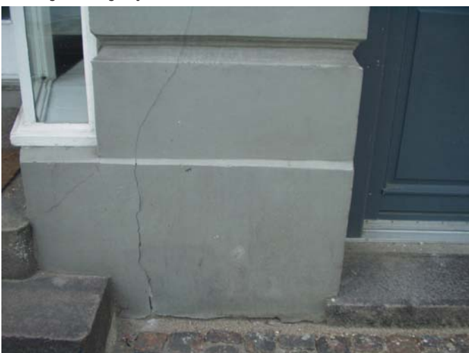
Sætningsrevne i gadefacade
