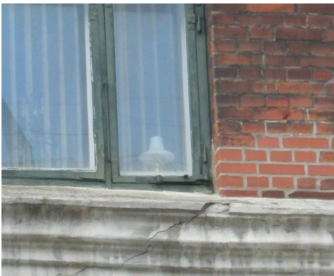
Facadeudsnit af sætningsrevner
