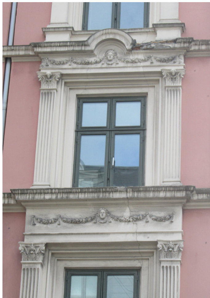
Facadeudsnit af nedbrudte gesimser og udsmykninger
