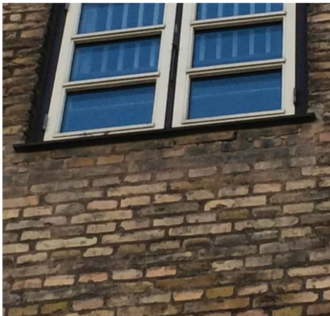
Overfacade fremstår med sætningsrevner
