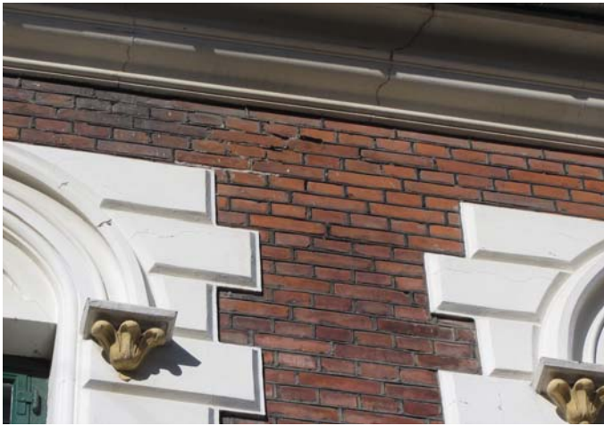
Murværk og fuger er væsentligt nedslidt på gadefacaden
