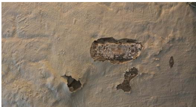
Fugt i kældervægge pga. dårlig ventilering
