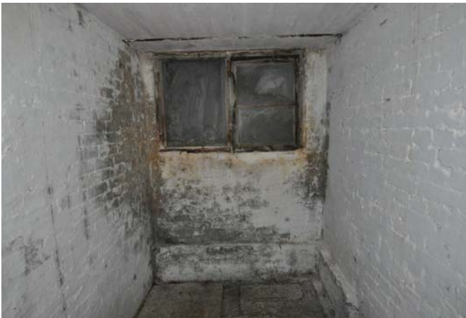
Tydelig fugt i kældervægge udbedres og ventilering forbedres
