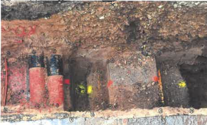
Billede 1. Foto af udgravning af Radius' 30 kV og Energinet.dk's 132 kV kabelanlæg i Trangravsvej. Fotoet er taget mod vest, således at nord er i fotoets højre side. 132 kV kablet HK1211 er kabelkassen i fotoets højre side, markeret med gul spray.
