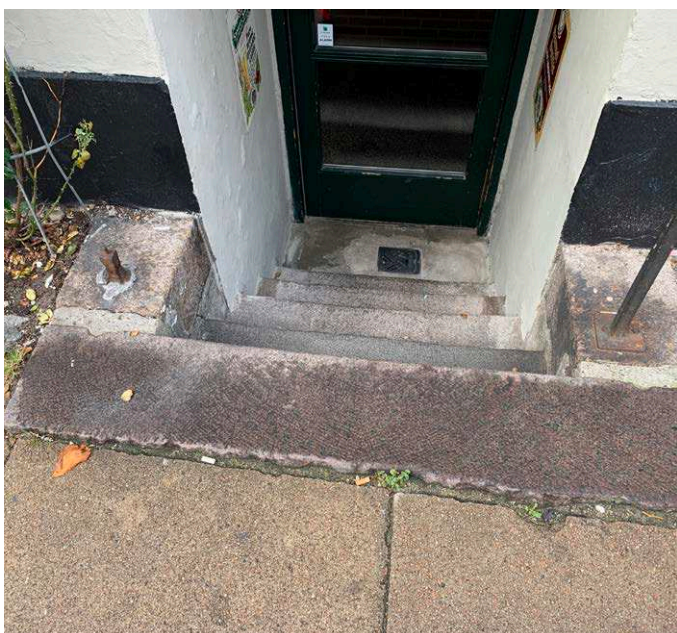
Manglende og defekte trappeværn genoprettes
