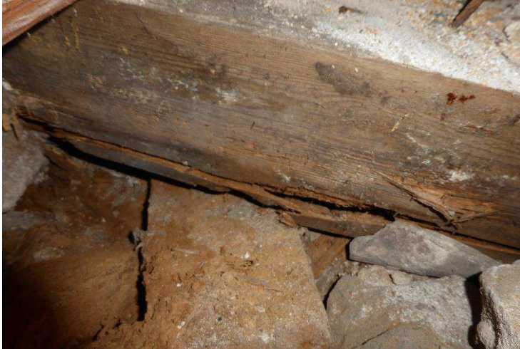
Synlig nedbrydning af bjælke i terrændæk
