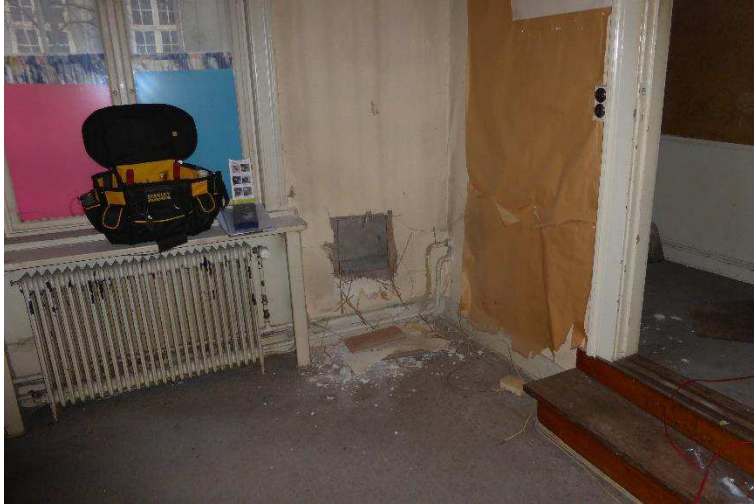
Undersøgelsesområde nr. UO2 i forsatsvæg på indvendig side af facademur
