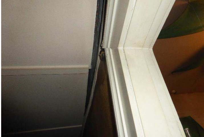
Synlig sætningssskade på træskillevæg
