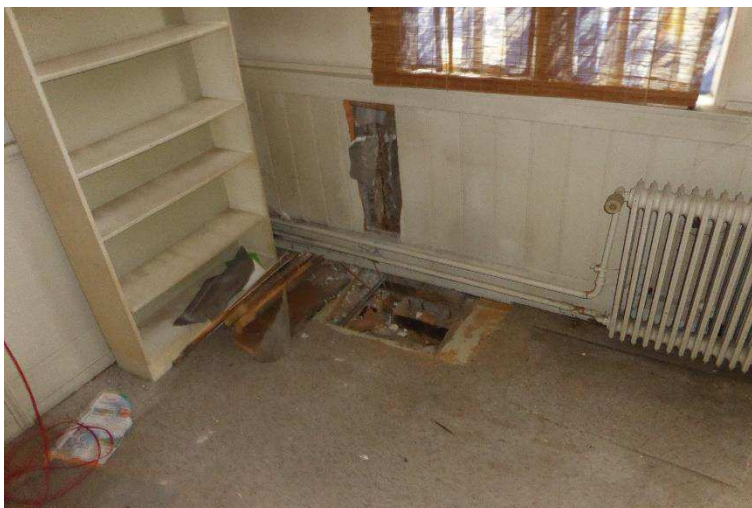
Undersøgelsesområde nr. UO4 i forsatsvæg på indvendig side af facademur og terrændæk
