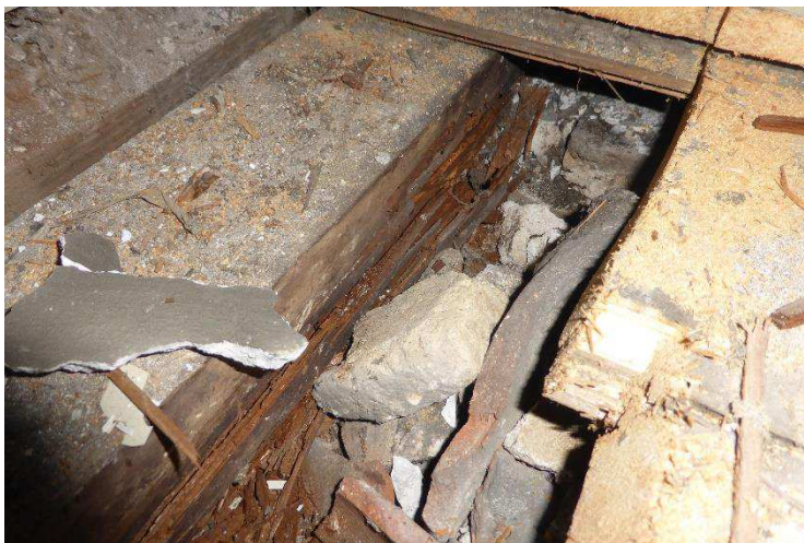
Synlig nedbrydning af bjælke i terrændæk
