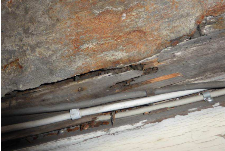
Synlig nedbrydning af bundrem i bindingsværkskonstruktion
