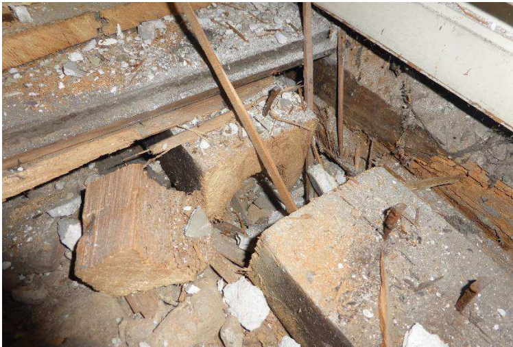
Synlig nedbrydning af bjælke i terrændæk
