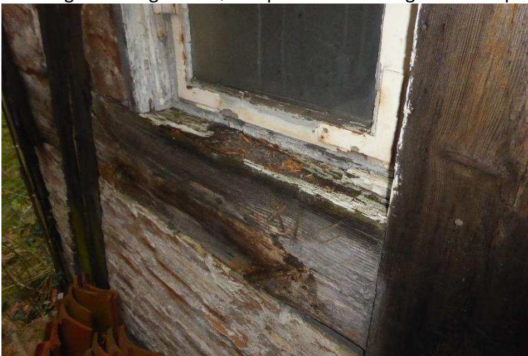
Rådangreb i vindue
