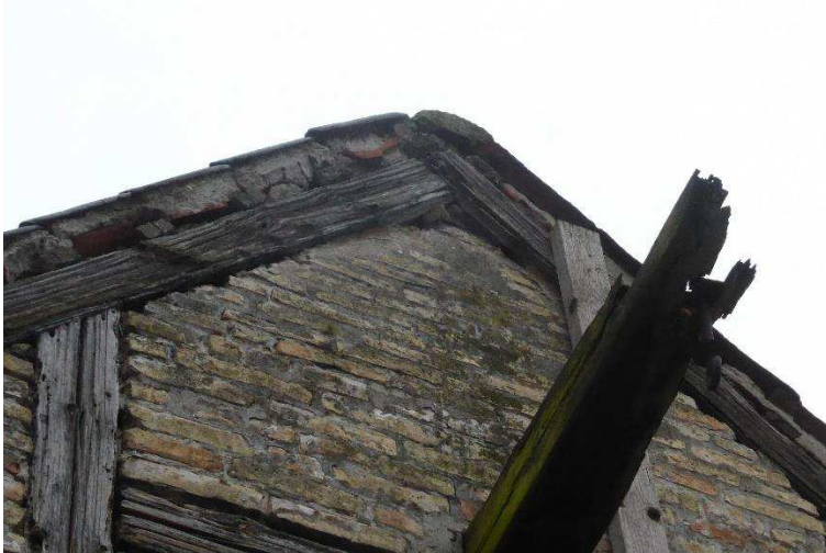
Synlig nedbrydning af den øvre del af bindingsværk i vest gavl
