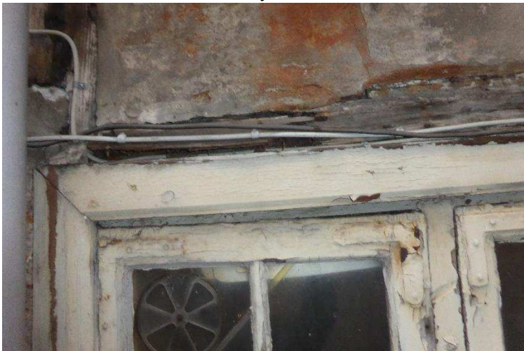
Synlig nedbrydning i løsholt over vindue
