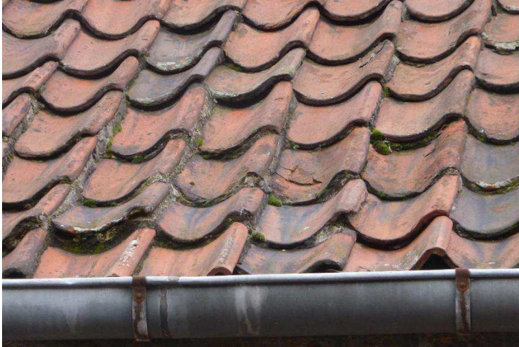
Synlige skader/nedslidning af tegltag
