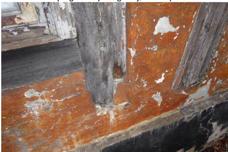
Synlig nedbrydning af bindingsværksstolpe i området ved fjernet bundrem
