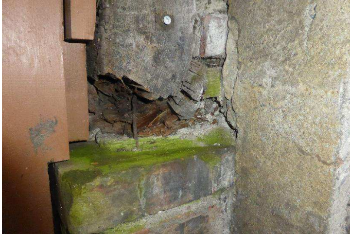
Synlig nedbrydning af bundrem bag støbt væg ved nedre del af vest gavl
