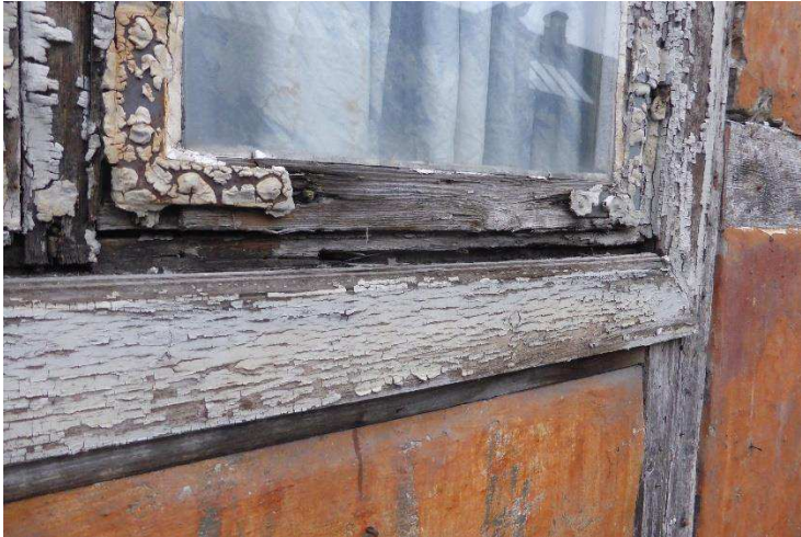
Synlig nedbrydning af vindue i syd facade
