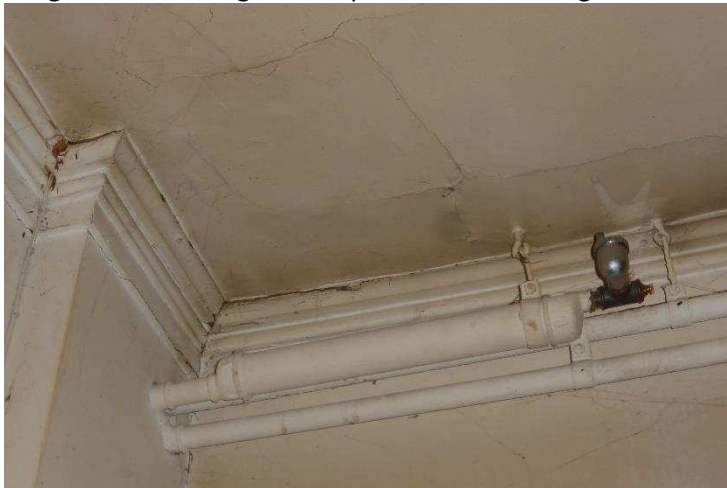
Synlige revner på pudset loftsoverflade
