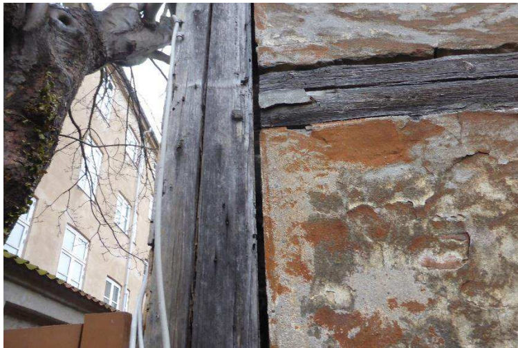
Områder hvor regnvand kan trænge ind i bindingsværkskonstruktion
