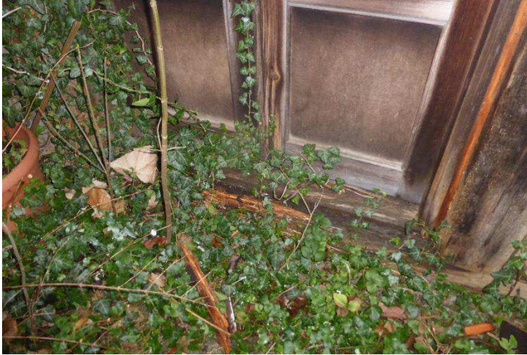
Synlig nedbrydning af bundstykke i dør
