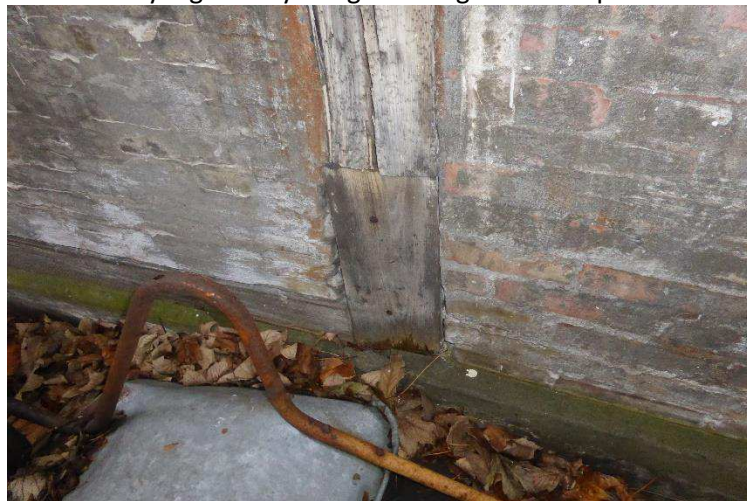
Rådangreb i tidligere udført reparation i bindingsværksstolpe
