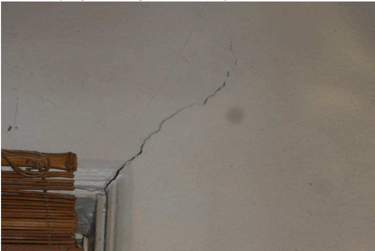
Synlige sætningsrevner ved hjørne over vindue
