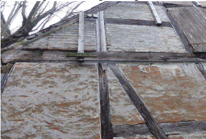
Synlig nedbrydning af bindingsværksstolpe i vest gavl
