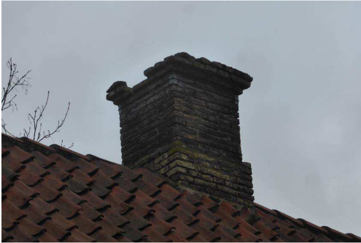
Synlige skader på skorstenspibe
