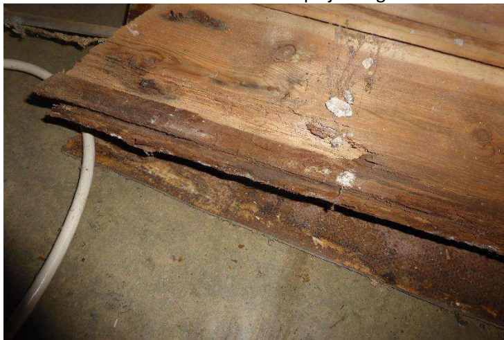
Synlig nedbrydning af optagne gulvbrædder i terrændæk
