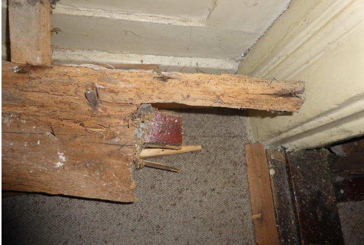
Synlig nedbrydning af optaget gulvbræt i terrændæk
