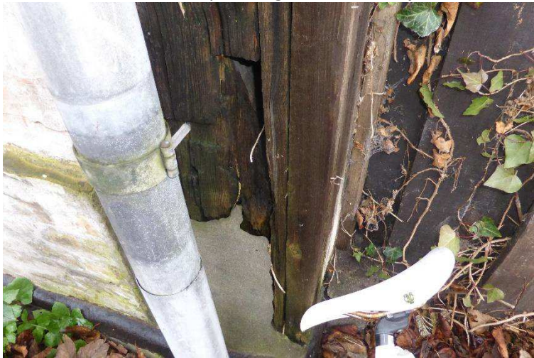
Synlig nedbrydning af hjørnestolpe
