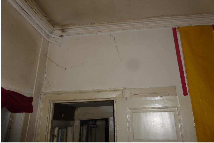
Område med registreret sætningsrevne i pudset træskillevæg samt ved loftsoverflade
