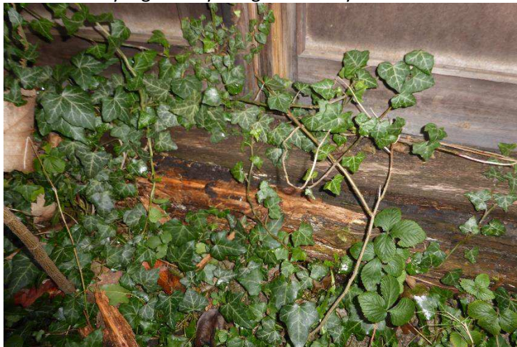
Synlig nedbrydning af bundstykke i dør
