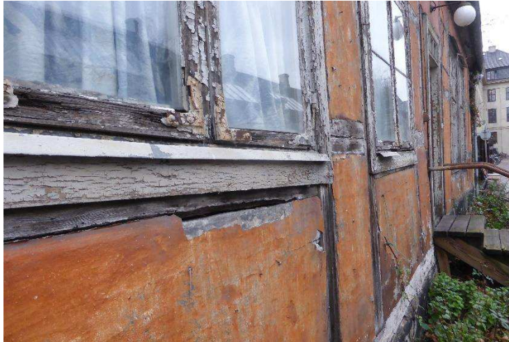
Synlig nedbrydning af vindue i syd facade
