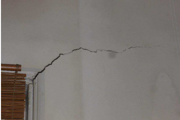
Synlige sætningsrevner ved hjørne over vindue
