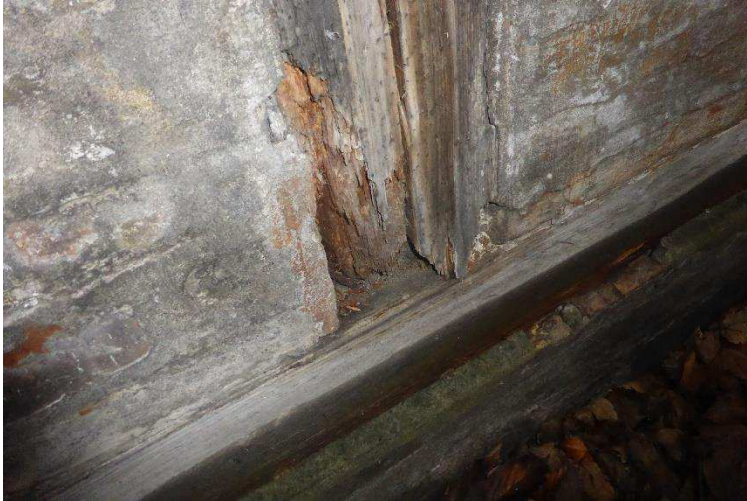
Synlig nedbrydning i bindingsværksstolpe
