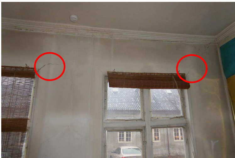
Områder med registreret sætningsrevner
