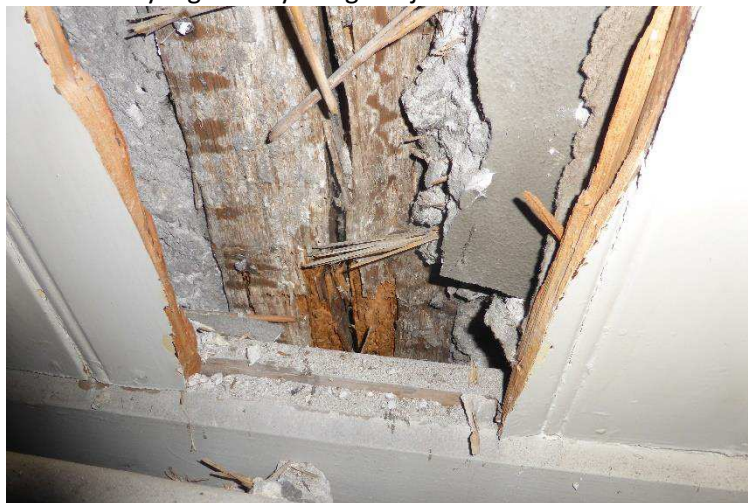
Synlig nedbrydning af bindingsværksstolpe i facademur
