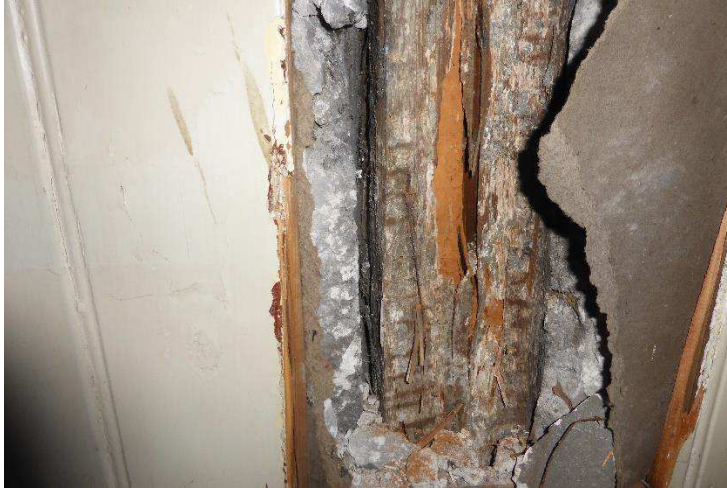
Synlig nedbrydning af bindingsværksstolpe i facademur
