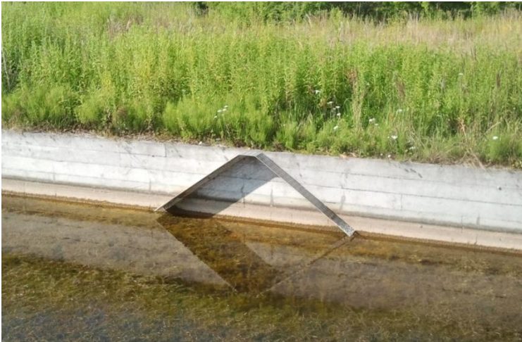
Figur 37. I stedet for en skrå og blød overgangszone er kanalens kanter hårde og lodrette betonkanter som dårligt opfylder de biologiske behov i området. Der er med store mellemrum opsat ramper som kompensation for dyrelivet, men bemærk luft under den nederste kant pga. lav vandstand
