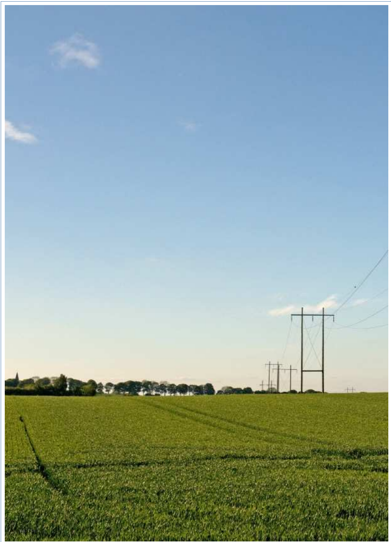
En ældre 60 kV ledning på træmaster. Flere og flere af disse ledninger vil blive lagt i jordkabler i de kommende årtier.
