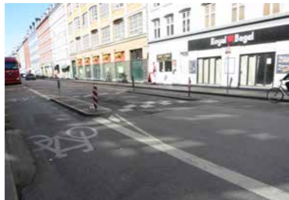
Vejbump på Rantzausgade har skabt lokal utryghed
