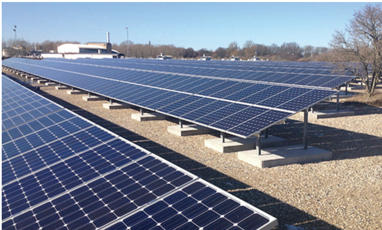
Refshaleøens Ejendomsselskab ønsker at opføre et solcelleanlæg på deres ejendom som led i deres strategi om at blive CO 2 -neutrale. Lynettefællesskabet har ved Damhusåen opført nordens største solcelleanlæg med en samlet effekt på 777 kW, hvilket vil mindske CO 2 -udslippet med 340 tons.
