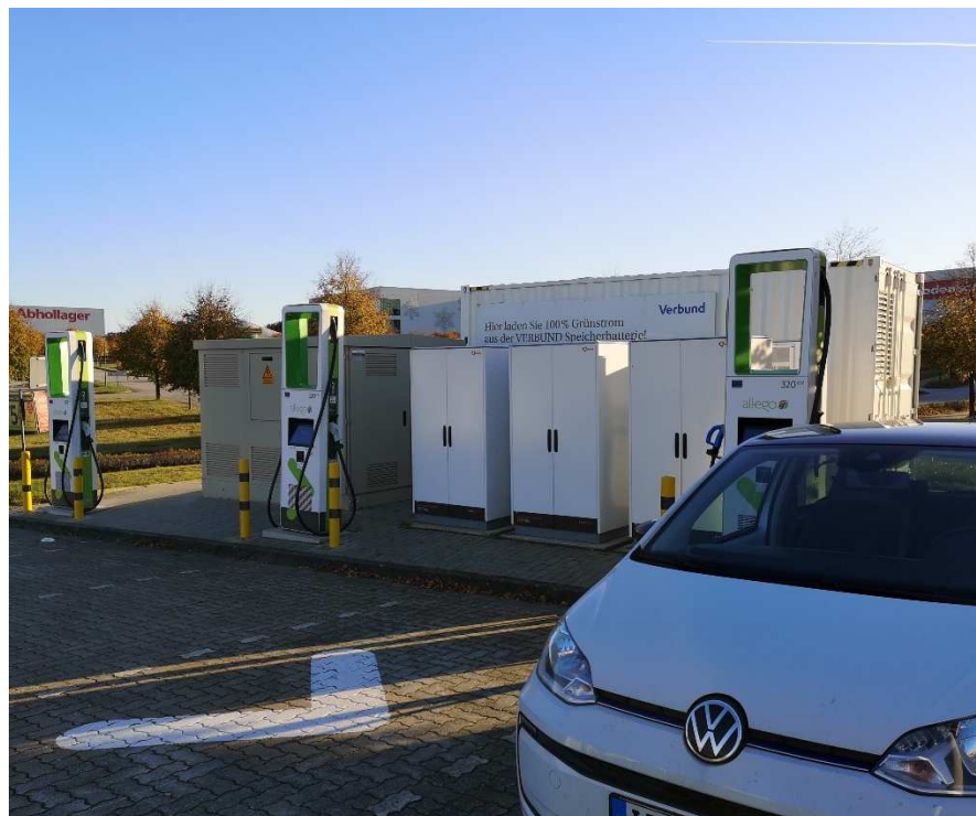
Figur 15: Eksempel på en ladehub med batteri-backup (placeret decentralt i containeren bagved teknikskabene). Fra Allego's ladehub i Kaltenkirchen, Tyskland
