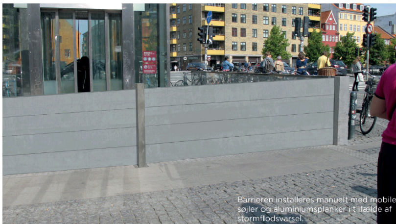
Figur 1: Eksempel på stop logs foran en elevatorskakt
