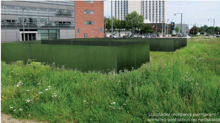
Figur 1: Eksempel på forhøjet rist med pladebeklædning ved Faste Batteri skakt
