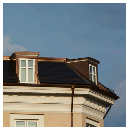
Tagboligprojekt i et nedlagt tørreloft med københavertag. Inddækninger af nye kviste mv. er udført af kobber.
