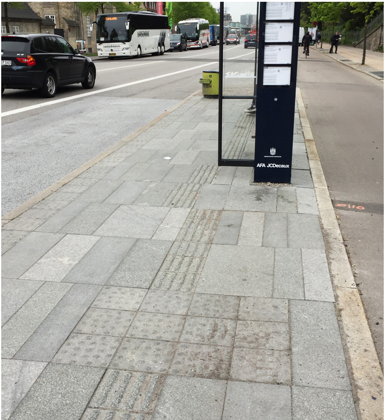
Foto af busperron på Voldgaderuten. Her fører ledelinjen ind i den nye buslæskærm, hvilket ikke er hensigtsmæssigt.
