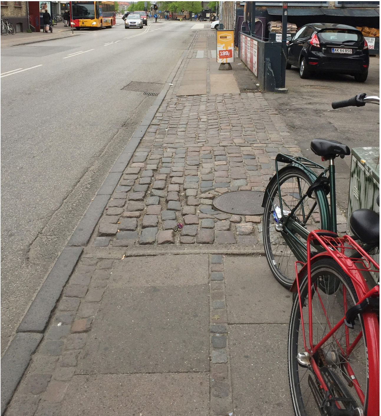
Foto af ujævn belægning på Fuglekvarterstruten.
