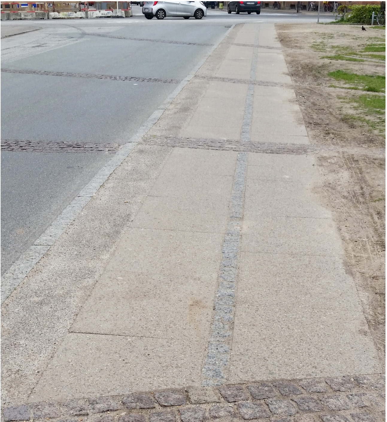
Foto af fortov på Sydhavnsruten, hvor belægning på tværs af fortovet skaber usammenhængende ledelinje.
