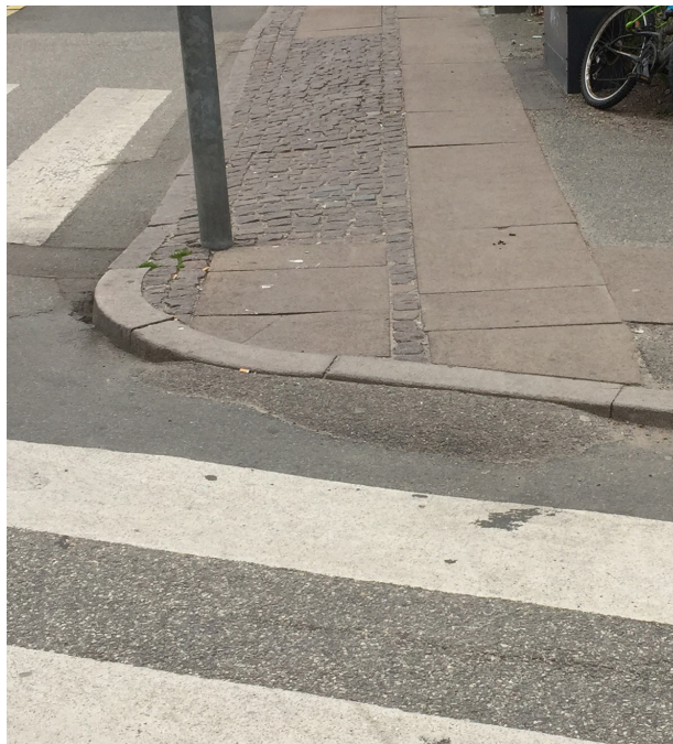
Rampe med lille lysning, der er besværligt for kørestolsbrugere at forcere. Samtidig er en for lille lysning ikke nok til at blinde og svagtseende kan mærke, om de med sikkerhed er på fortovet.
