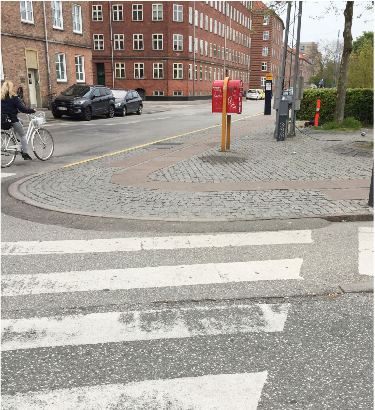
Foto af stejl rampe ved fodgængerkrydsning på Lergravsruten. Desuden mangler fodgængerkrydsningen retnings- og opmærksomhedsfelt, nulkant og opspring for blinde.
