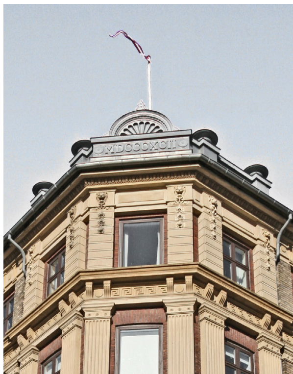
Skydebanegade. Den meget markante gesims vil være svære at gennembyrde med en god helhedsvirkning.
