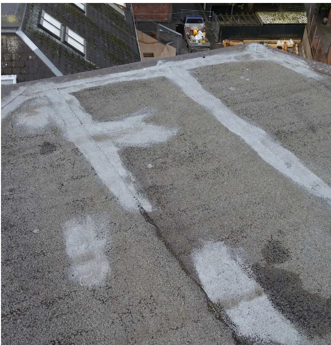
Taget er væsentligt nedslidt.
