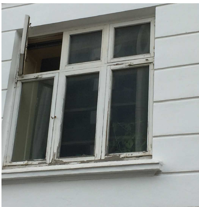
Ejendommens vinduer er nedslidte og udskiftes.
