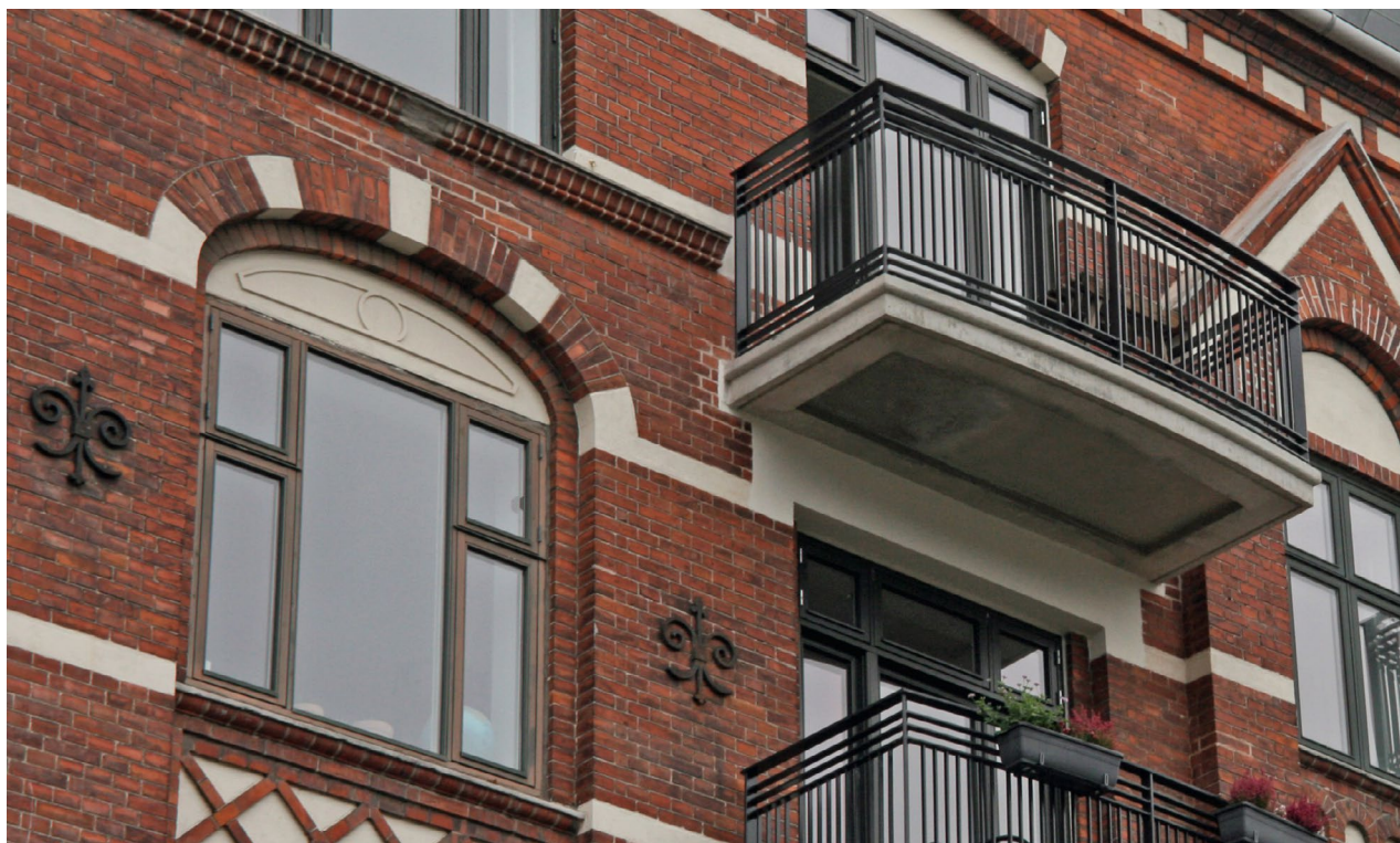
Sankelmarksgade. Buen over vinduet er fjernet men der er skabt en god helhedsvirkning ved at lade det lyse dekorative bånd skabe en naturlig overgang. Betonbundens stoflighed og fine detaljering harmonerer med facaden.
