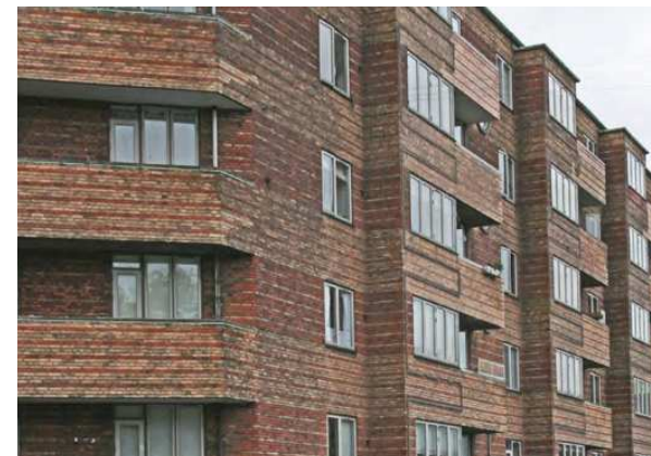
Sankt Kjeldes Plads 5 Oprindelige murede altaner der følger vinduesbåndene som et centralt motiv på facaden.
