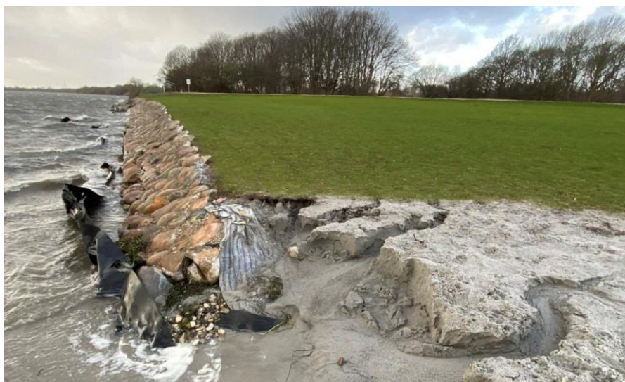
Figur 1 Billede fra februar. Erosion, der viser de blotlagte membraner. Indsendt af ansøger.
