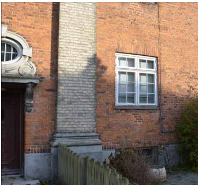
Murværket har mange steder dårlige fuger og sætningsrevner.
