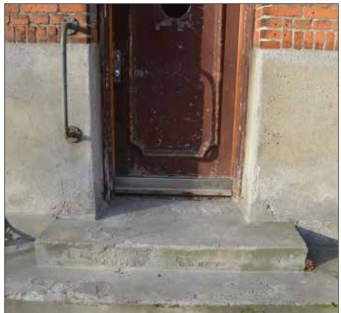
Døre er utætte og pudsen på soklen faldet af mange steder.
