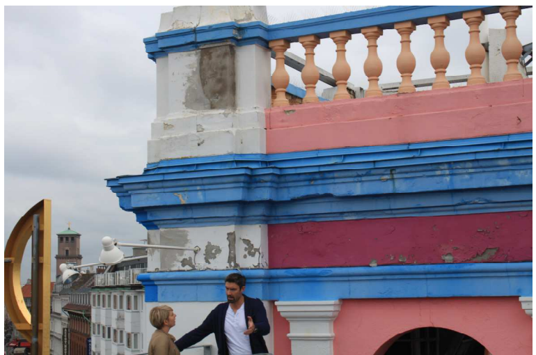
Tydelige skader på yderside af tårn
