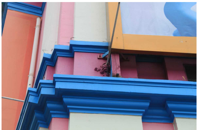
Gamle forankrin- ger og beslag svækker murværk
