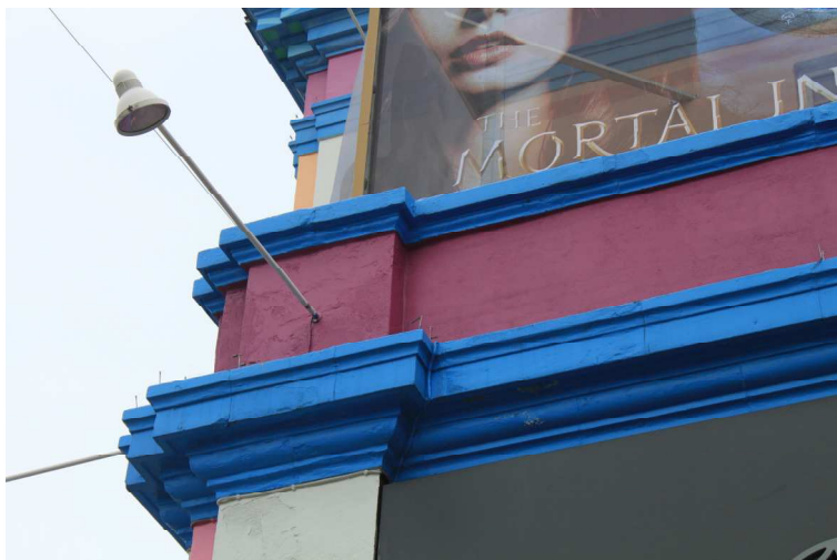
Belysningsstander på facade
