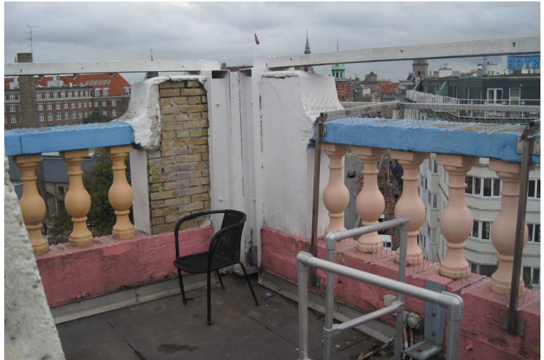
Gammelt beslag fra "Palads skilt" på tårn – fugtska- det murværkshjør- ne
