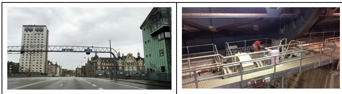
Langebros i København har så alvorlige skader, at den akut skal renoveres - her er vi inde i broen til eftersyn i 2019
