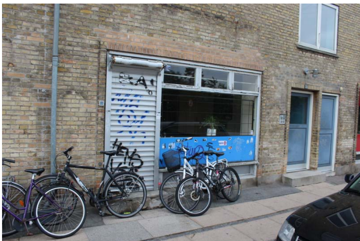
Nedslidte facader på Borgbjergsvej
