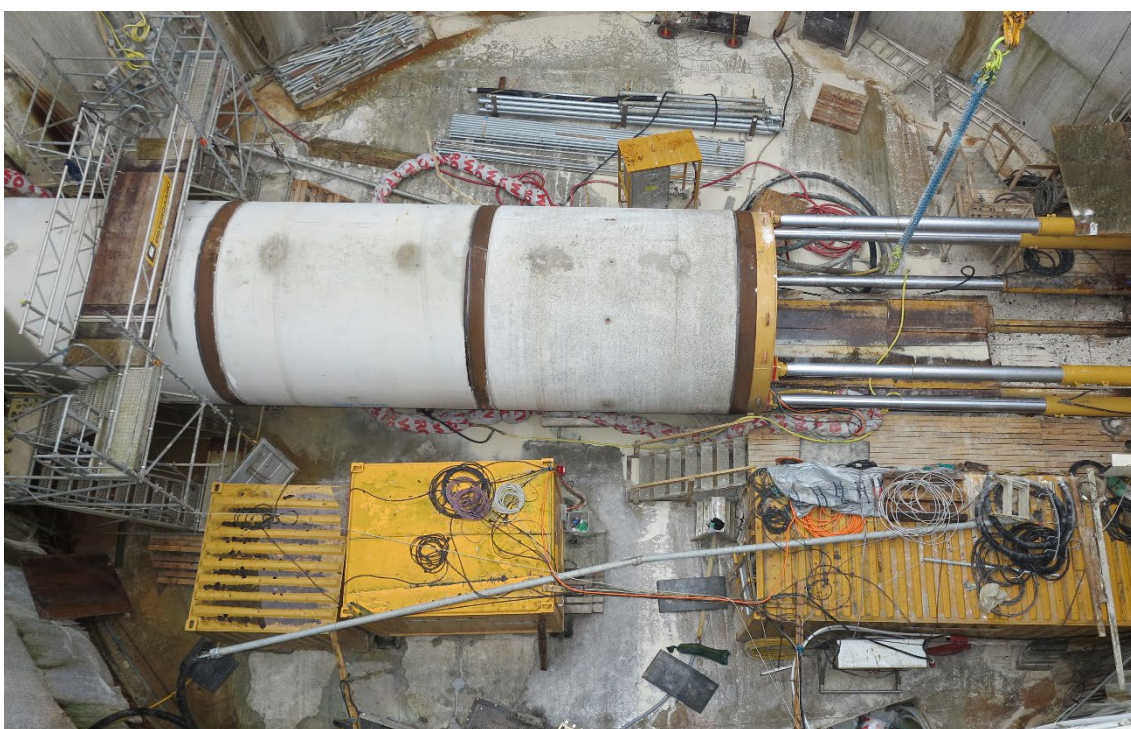
Figur 5.14: Skakt (pressegrube) set fra oven, hvor betonelementerne presses ind i tunnelen (pipejacking).
