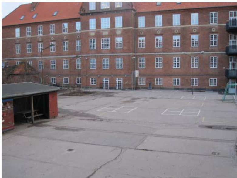
Størstedelen af skolegården er i dag belagt med nedslidt asfalt.
