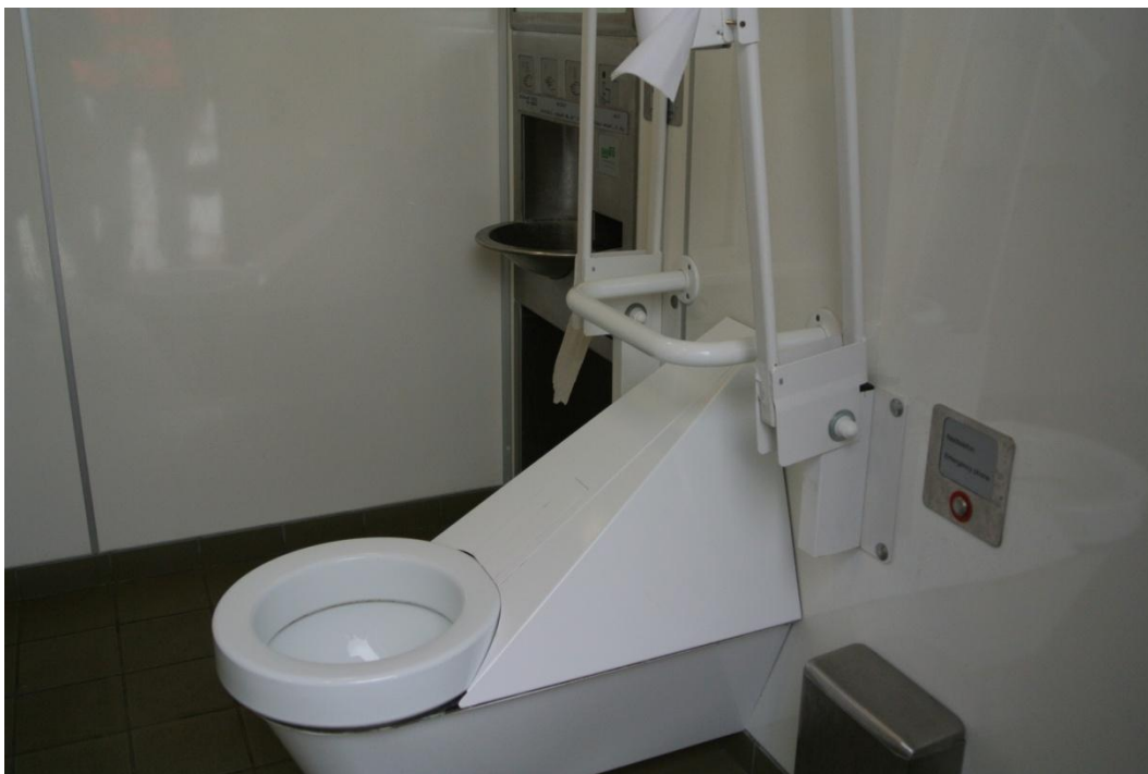
Illustration 8 – Metalboks, toilet, armstøtter og håndvask
