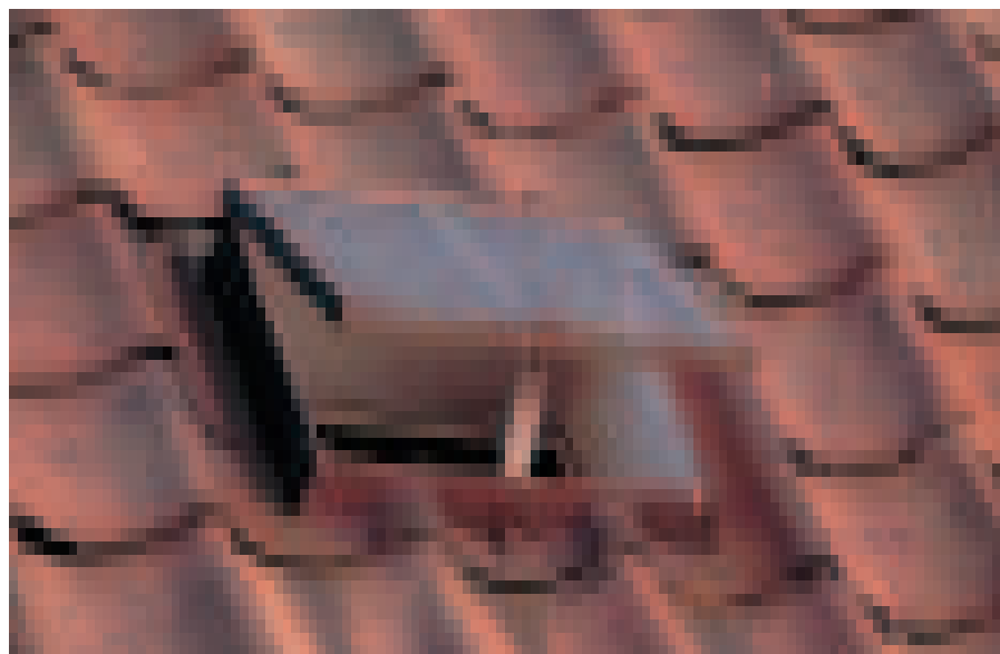
Originalt tagvindue i støbejern.
